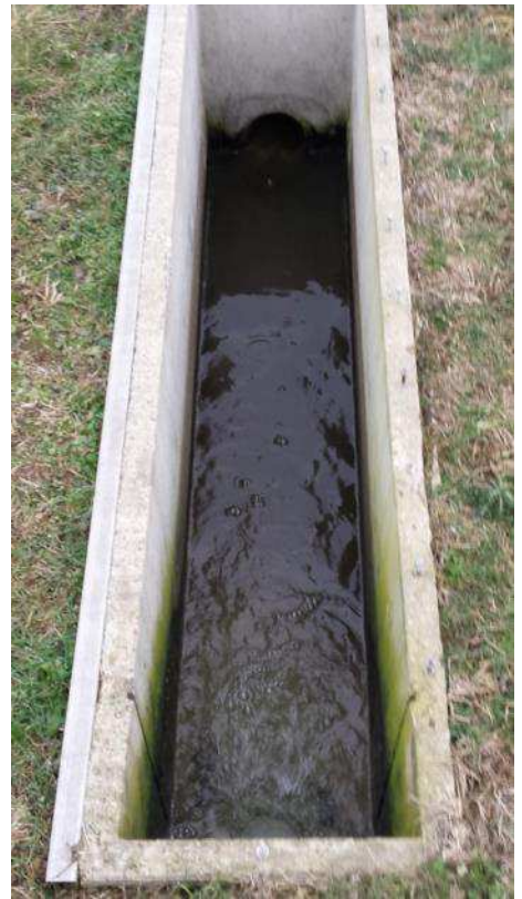
Photo 19 : Canal de comptage
