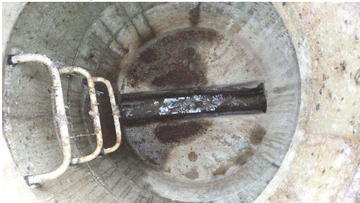
Photo 4 : Regard de sortie
