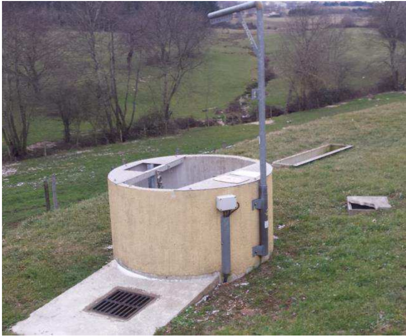
Photo 18 : Poste de relevage
