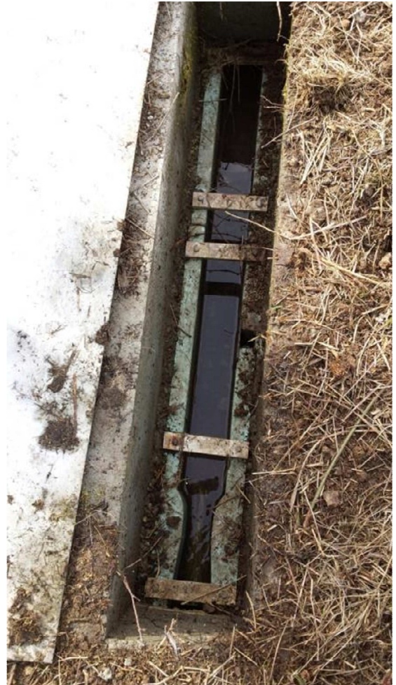
Photo 2 : Canal de comptage
