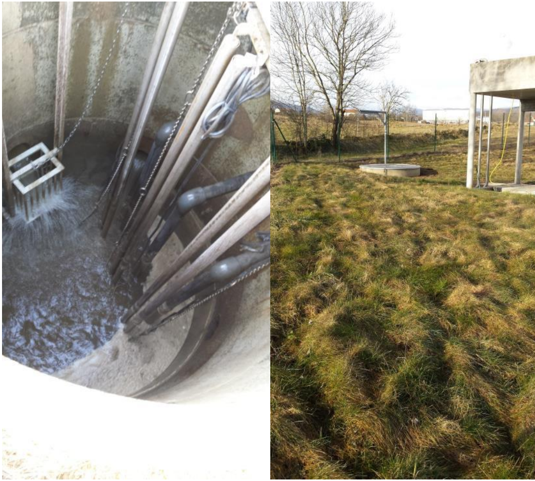
Photos n°1 et 2 : Photos intérieure et extérieure du poste de relevage
