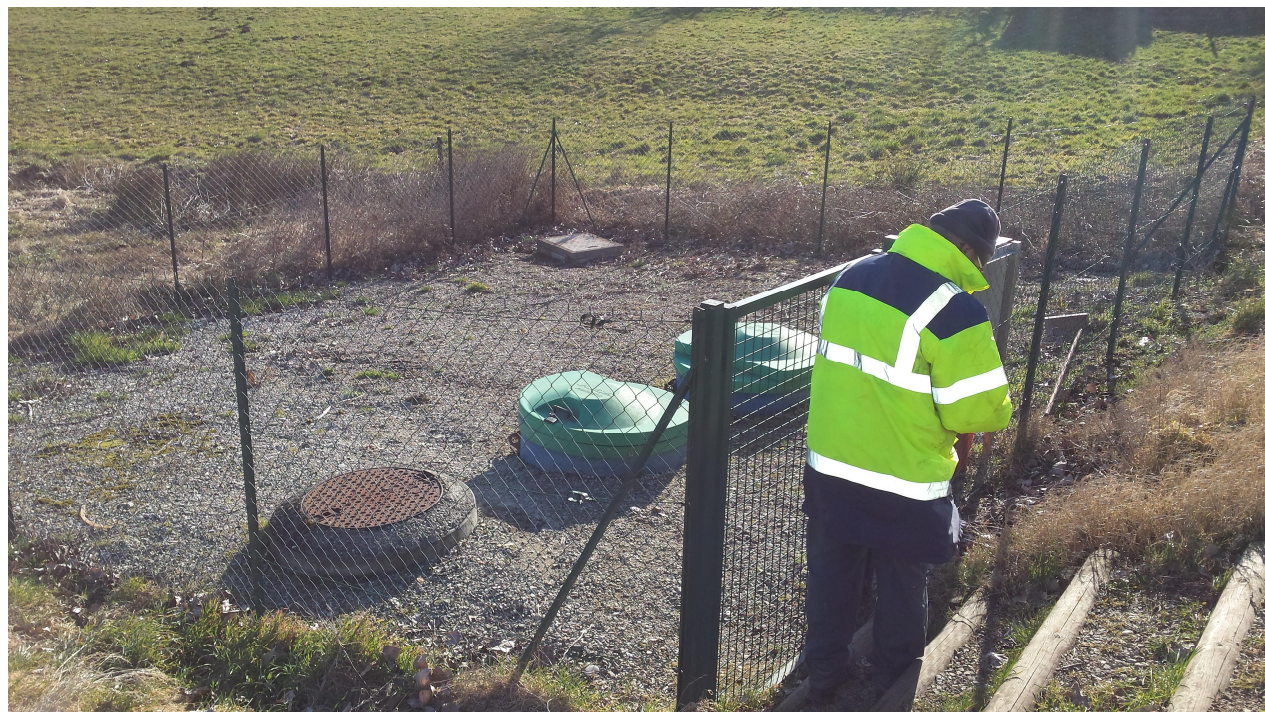
Photo n°3 : Vue extérieure du poste de refoulement du Ranchet
