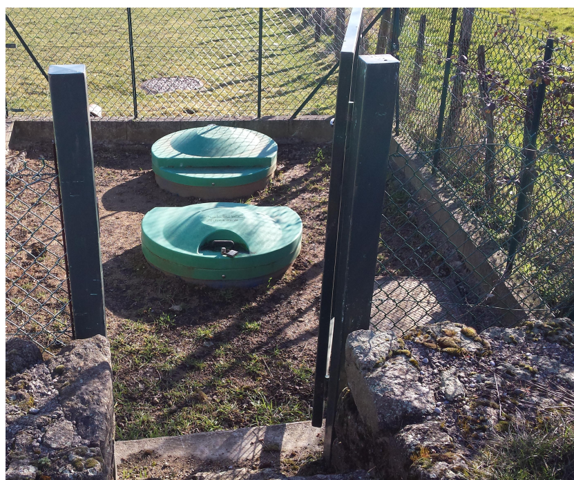
Photo n°3 : Vue extérieure du poste de refoulement de Seytenas
