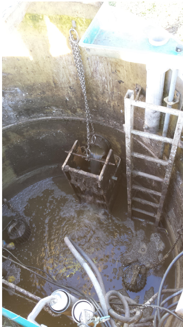
Photo n°1 : Vue intérieure du poste de refoulement du Pontet
