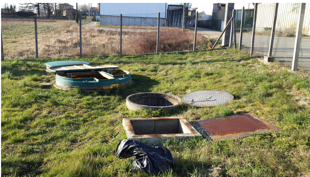
Photo n°3 : Vue extérieure du poste de refoulement du Pontet
