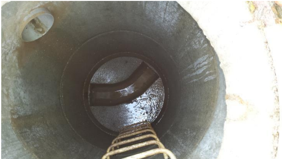
Photo n°3 : Regard by-pass de la station.
