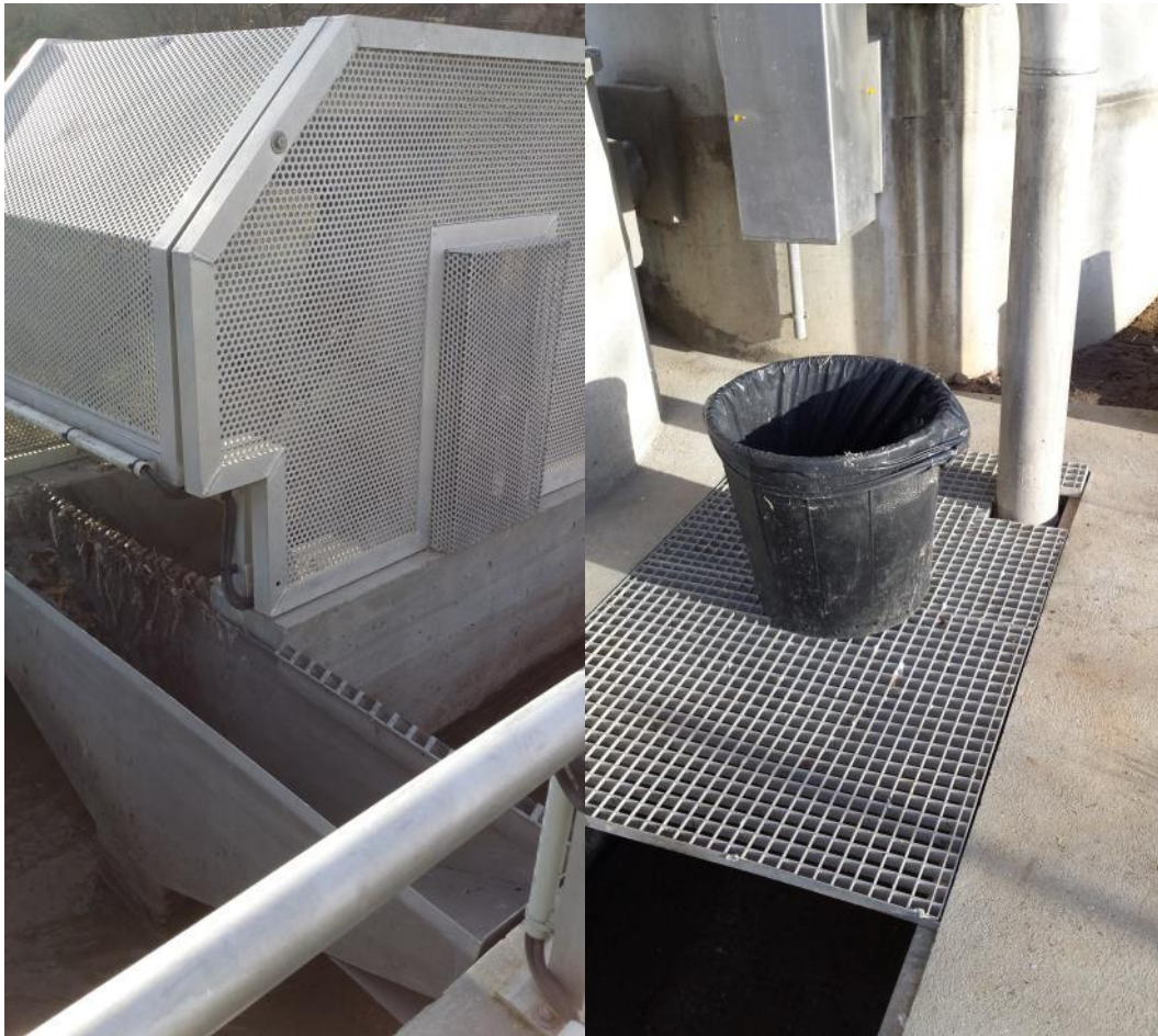
Photo n°4 et 5 : Dégrilleur mécanique et évacuation des refus de grille.
