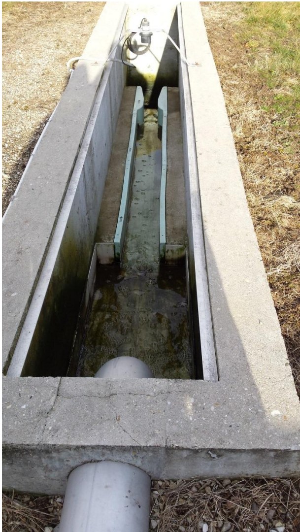
Photo n°9 : Canal de comptage sortie
