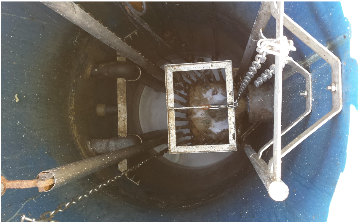
Photo n°1 : Vue intérieure du poste de refoulement du Ranchet
