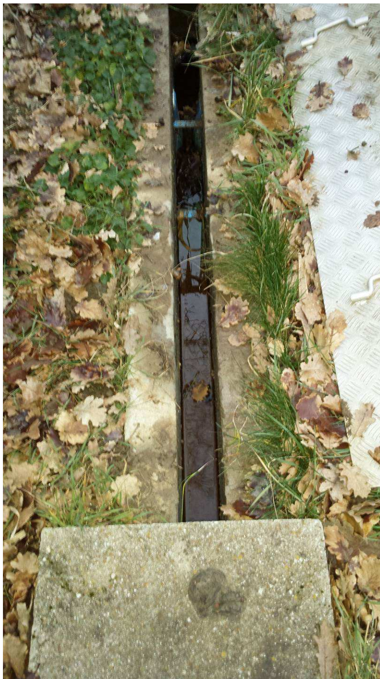
Photo n°9 : Canal de sorti des eaux traités
