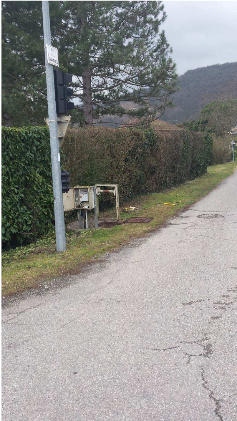
Photo n°3 : Vue extérieure du poste de refoulement de Peyraud
