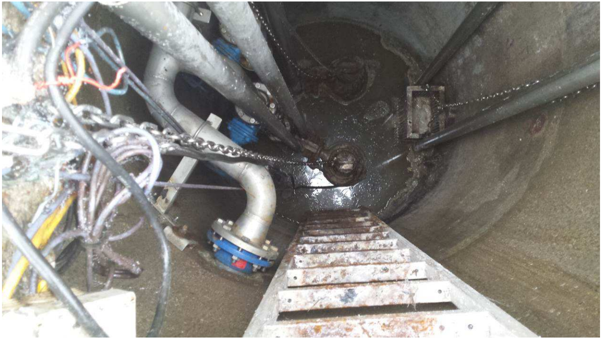
Photo n°1 : Vue intérieure du poste de refoulement de Peyraud
