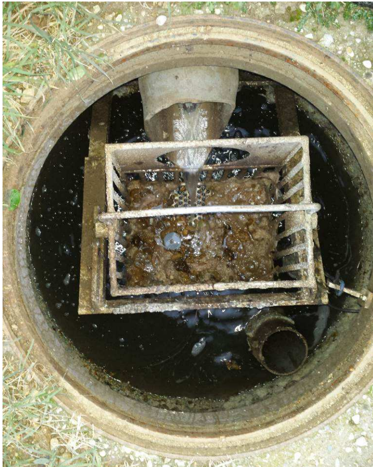
Photo n°6 : Arrivée des effluents – panier dégrilleur
