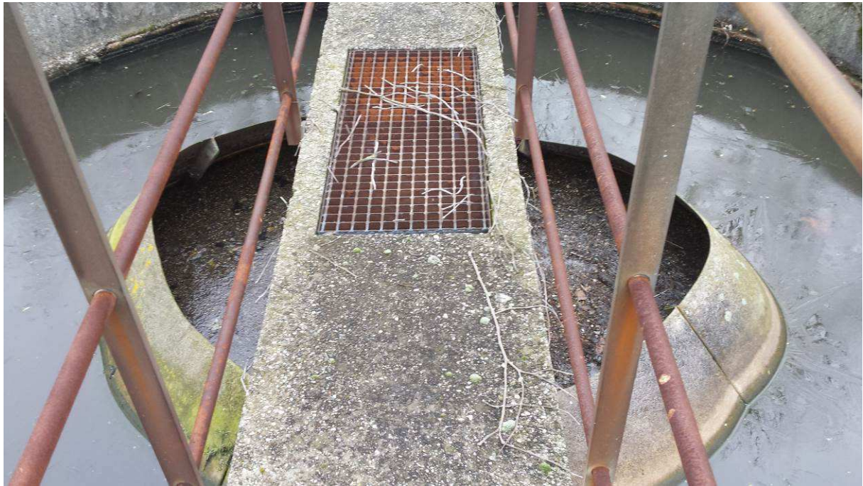
Photo n°3 : Décanteur digesteur – vue du dessus – Caillebotis en mauvais état
