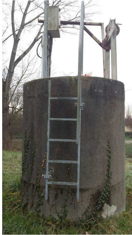
Photo n°1 : Poste de relevage en entrée de station – présence de quelques fissures
