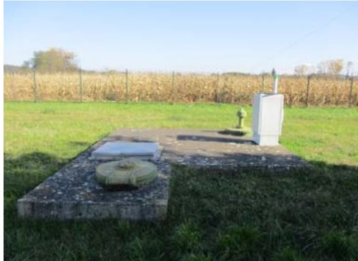
Figure 51: Photographie de la bache de secours de 5m3 située à Fromental
