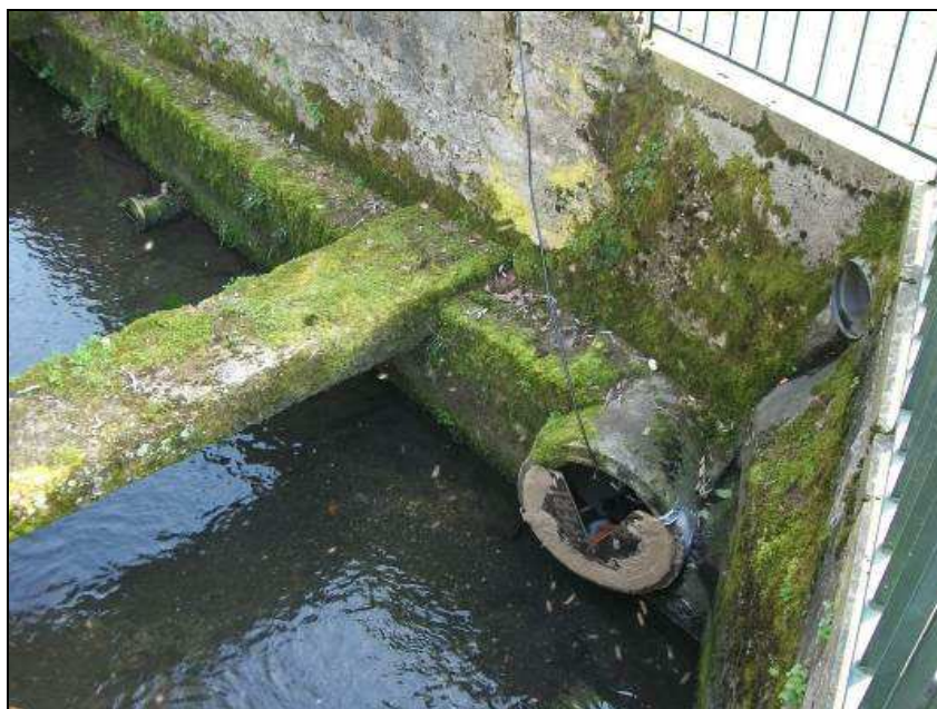
Seuil normalisé et sonde de hauteur – Point 2
