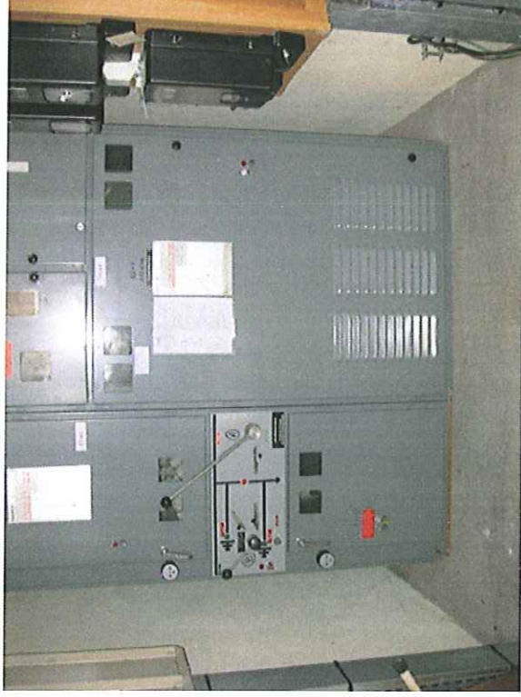
Transformateur du Puits du Marais - Chirens
