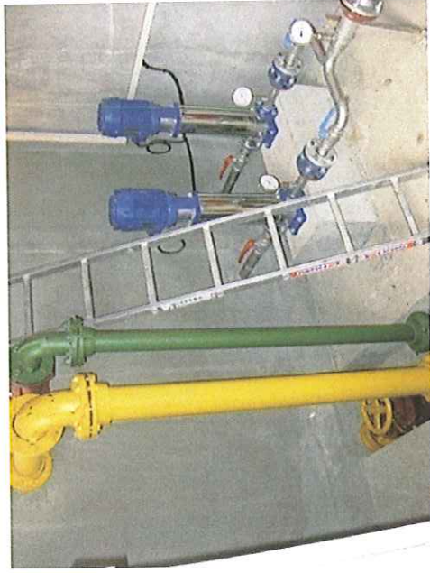
Station de pompage de la Charamelle Saint Etienne de Crossey
