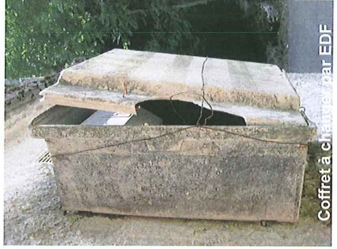
Station de pompage de Racin Voreppe
