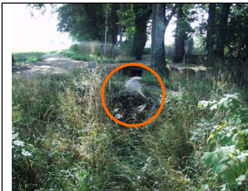
Photo, point :34 Coordonnée GPS : 46.26626 6.11648 Type : Canalisations sur le Gobé Nature : Béton Dimension : \phi 1000 Localisation : juste en amont de la confluence du Gobé et du Gobé2 Remarque : ne coule pas.
