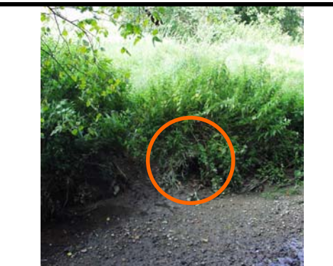
Photo, point : 37 Coordonnée GPS : 46.25773 6.12187 Type : tuyau Nature : béton Dimension : \phi 400 Localisation : \phi rive droite du Gobé Remarque : encombré par la végétation. Draine le fossé d'une zone de champs
