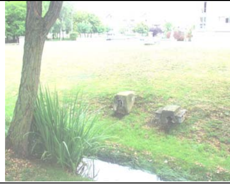
Photo, point : 8 Coordonnée GPS : 46.25747 6.11442 Type : 2 tuyau Nature :PVC Dimension : \phi 200 ; \phi 300 Remarque : 2 drains se jetant dans l'Ouye
