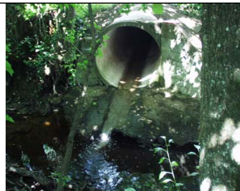
Photo, point : 36 Coordonnée GPS : 46.25806 6.12208 Type : tuyau EP Nature : Béton Dimension : \phi 1200 Localisation : rive droite Gobé Remarque : coule
