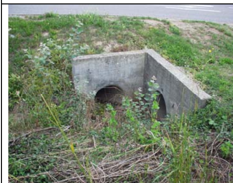
Photo, point : 51 Coordonnée GPS : 46.25011 6.10198 Type : traversé chemin agricole + route Nature : béton Dimension : \phi 600 Remarque : fossé encombré.
