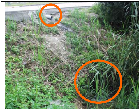
Photo, point : 62 a Coordonnée GPS : 46.24927 6.08588 Type : traversée route (sortie ouvrage vanné) Nature : béton Dimension : \phi 600 Remarque : vue avale
