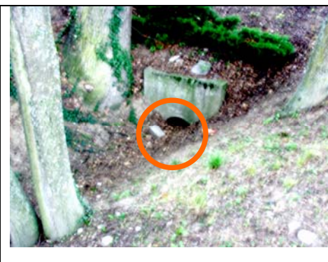
Photo, point : 52 Type : tuyau Nature : béton Dimension : \phi 600 Remarque : bouché par feuillage
