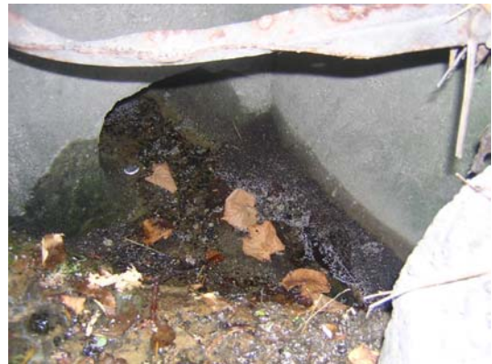
Photo 8 : détails de l'entrée en conduite
