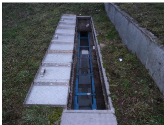
Fig. 4. Canal de suivi du trop-plein du poste
