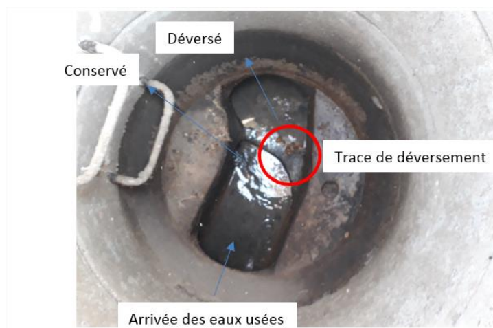
Fig. 26. Déversement des eaux chlorées de vidange de la piscine DO626
