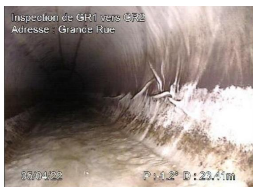
Fig. 76. Défauts dans le chemisage existant
