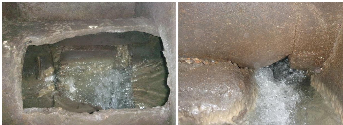
Fig. 42. Défaut structurel du DO8
