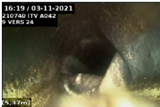
D : Problème structurel important
