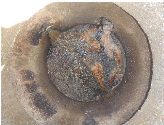
Regard 147 : absence de cunette
