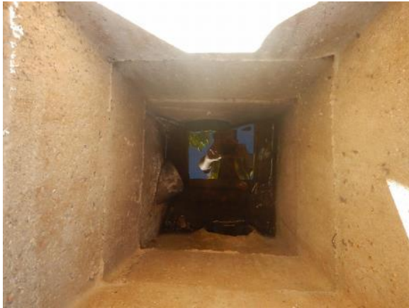
Regard 51 : absence de cunette
