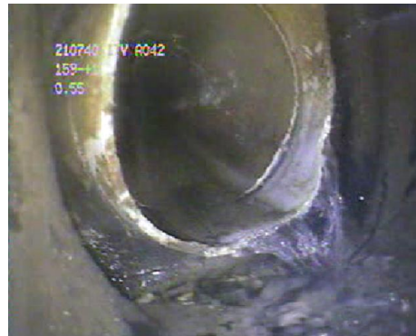
C : Infiltration sur jonction du branchement
