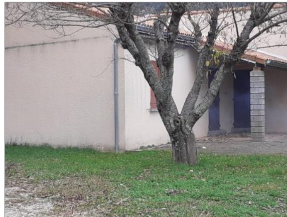
Anomalie 5 (gouttière suspectée)
