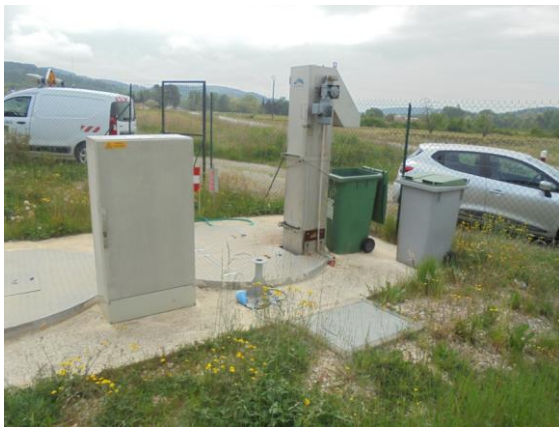
Dégrilleur et PR entrée STEP
