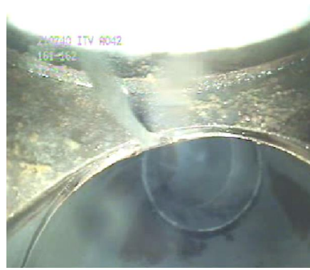
B : Infiltration sur raccordement par selle carottée
