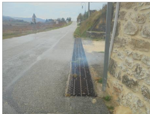
Anomalie 24 (Chemin de grille)
