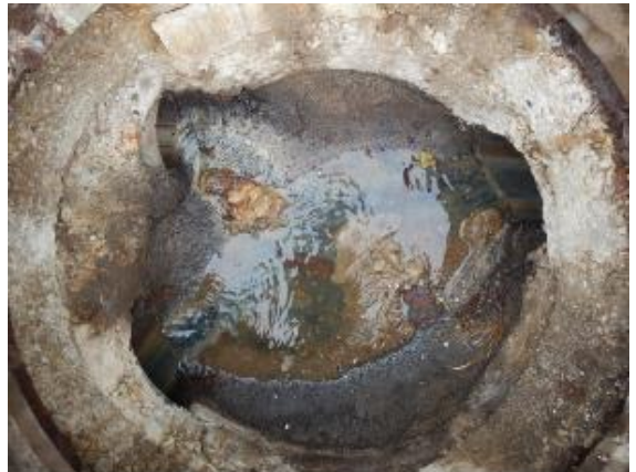
Regard 110 : absence de cunette
