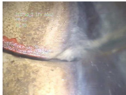
E : Infiltration au niveau des joints
