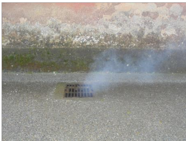
Anomalie 22 (avaloir suspecté)
