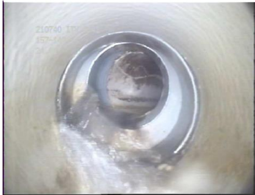
A : Infiltration importante
