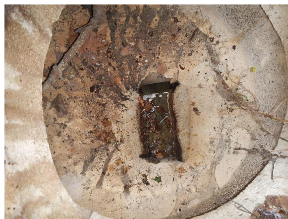
Regard 117 : virole décalée et infiltration depuis le fossé pluvial
