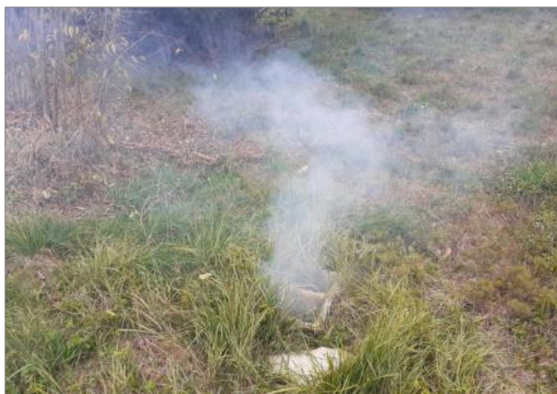
Anomalie 4 (boite de branchement non étanche)
