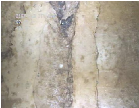
F : Revêtement en mauvais état
