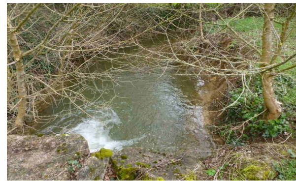
Erosion en berge en aval de l'OH6
