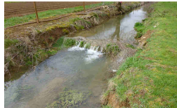
Seuil marneux avec usage de prise d'eau d'irrigation
