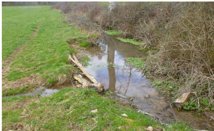
Brèche en RD du bief
