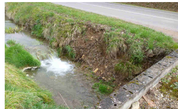
Admission de l'OH7 + érosion le long de la RD82
