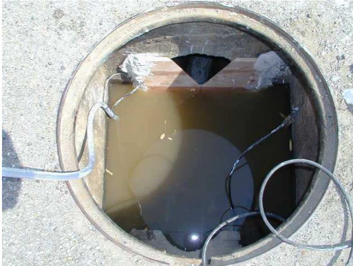
Mesure de débit en réseau : déversoir triangulaire
