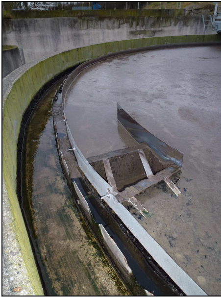
Fig. 3-d : Photographies du clarificateur
