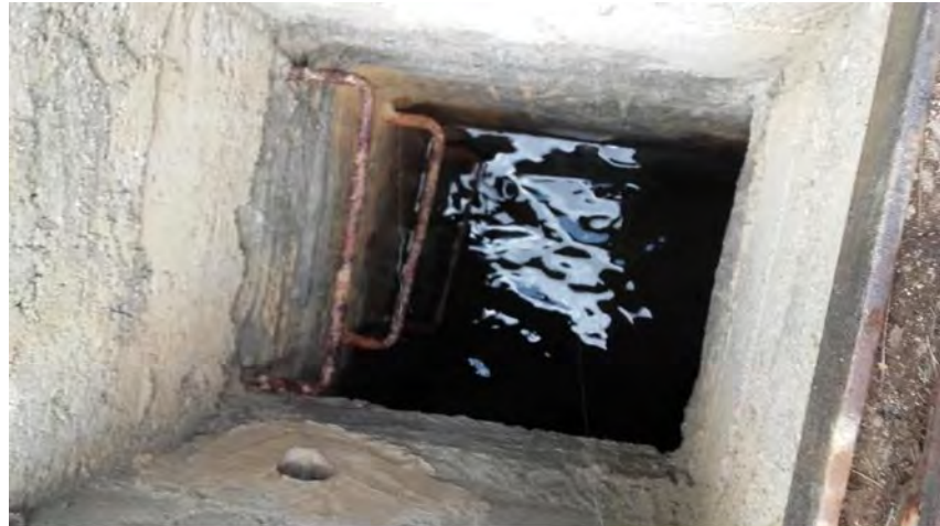
Illustration 2 : Réservoir de la commune de La Garde
