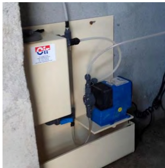
Illustration 3 : Dispositif de traitement au chlore
