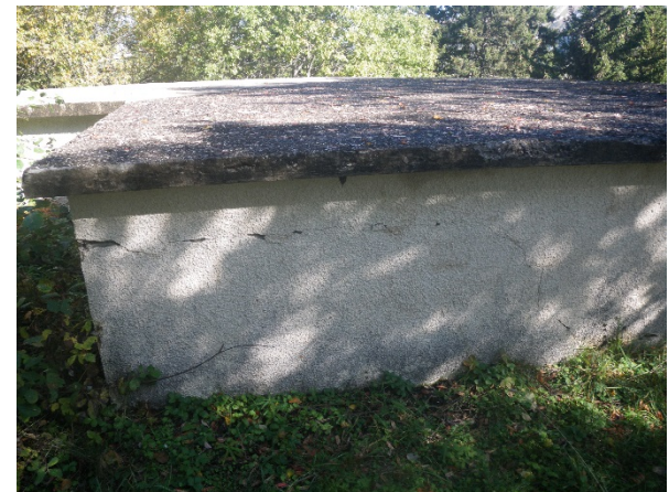
Fissures sur la maçonnerie extérieure
