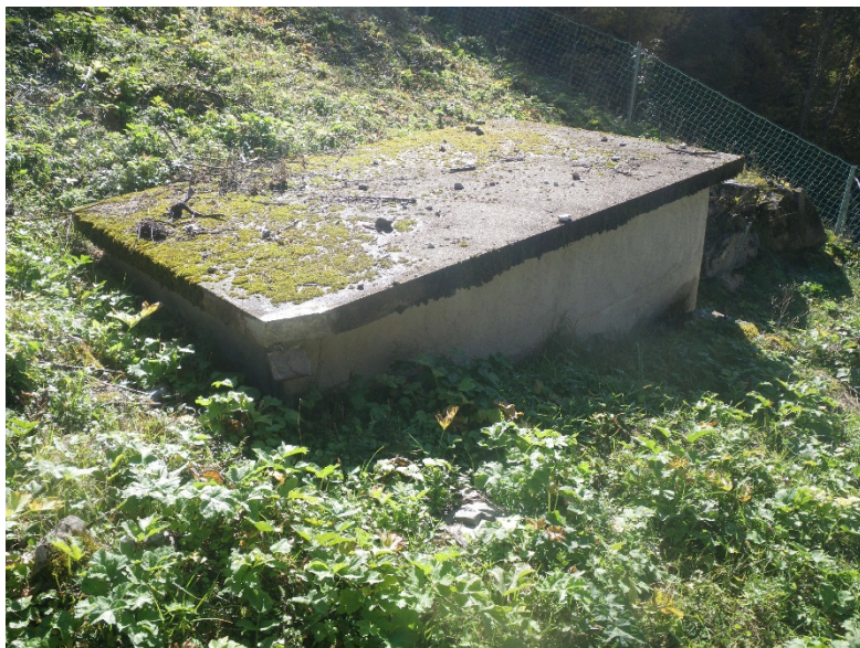
Présence de mousse sur le plafond
