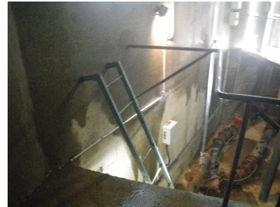
Accès à la cuve 2 et traces d'infiltration sur l'ensemble de l'ouvrage
