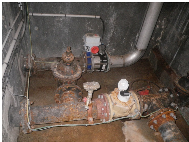
Caillebotis et conduites corrodés
