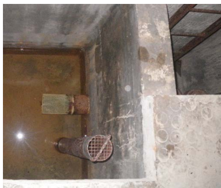
Crépine, trop plein et échelle corrodés
