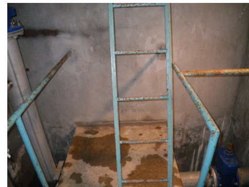
Echelles et garde-corps corrodés
