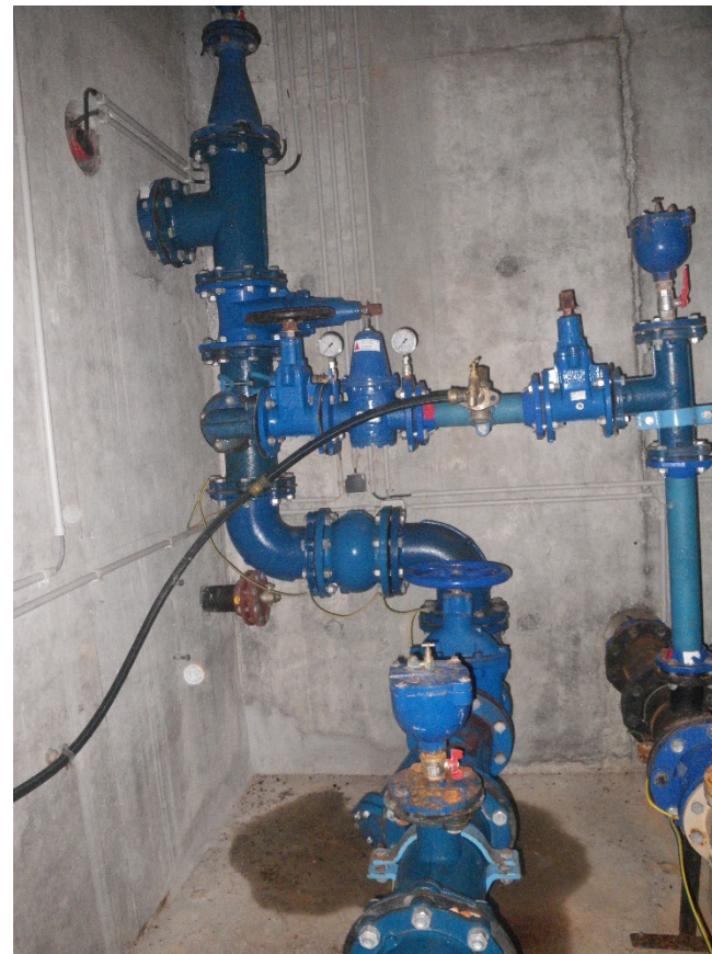
Traces de fuites
