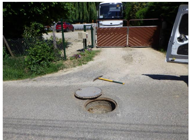
Virole dégradée – Regard 148 – vue extérieure – Chemin du Mollard
