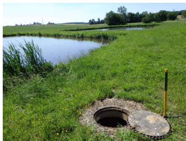
Roseaux dans le bac du récupération des flottants
