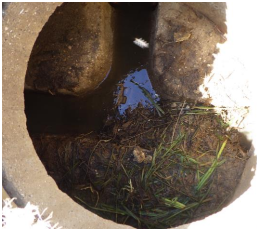
Dépôts - Regard 18 – Intermédiaire entre les lagunes
