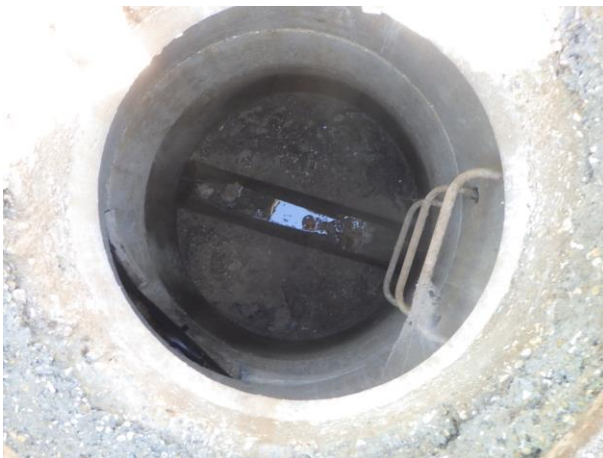
Virole dégradée – Regard 148 – vue intérieure – Chemin du Mollard
