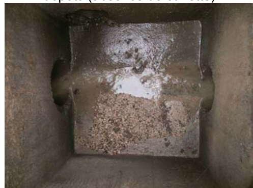
P6 – Absence de cunette
