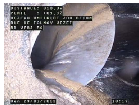
Raccordement – piquage direct – buriné à 12 heures (Apport d'eaux claires parasites)
