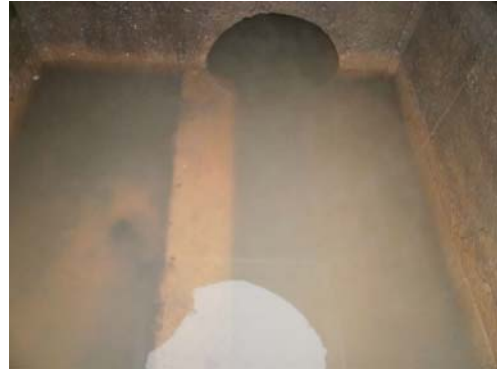
P2 – DO en charge, le déversoir n'est plus fonctionnelle (les eaux usées vont dans le réseau d'eaux pluviales et donc au fossé)
