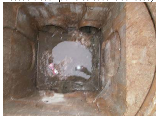
P4 – Stagnation des effluents, présence de dépôts (absence de cunette)
