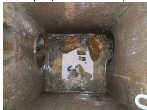
P10 – Stagnation des effluents, présence de dépôts (absence de cunette)
