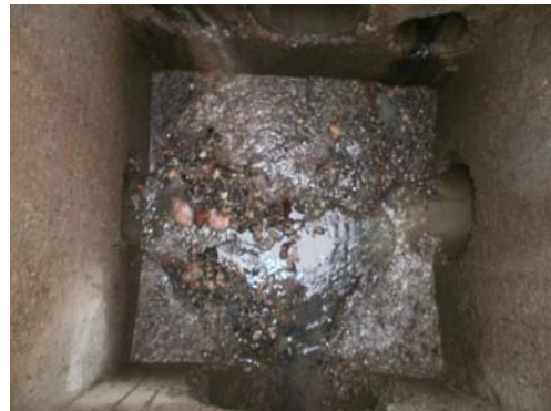
P8 – Stagnation des effluents, présence de dépôts (absence de cunette)
