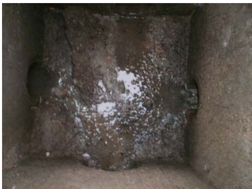
P5 – Stagnation des effluents, présence de dépôts (absence de cunette)
