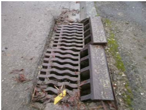
P7 – Grille défectueuse
