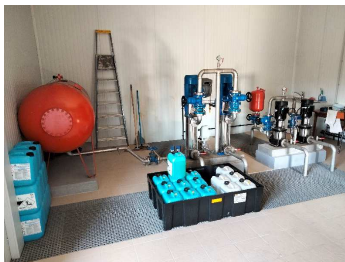
Photo des groupes de pompage de Renédale et du réservoir de tête de Ouhans
