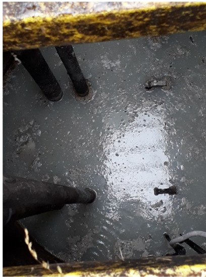
Figure 5 : Effluents chargés du poste de relevage CORNU
