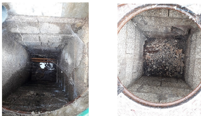
Figure 16 : Regard de collecte sur le tronçon unitaire
