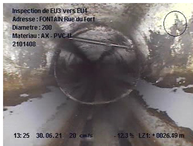
Joint défectueux pénétrant non-rompu (Tronçon EU3-EU4)
