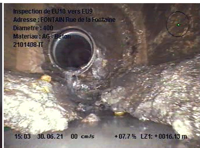
Cunette défectueuse (Tronçon EU9-EU10)
