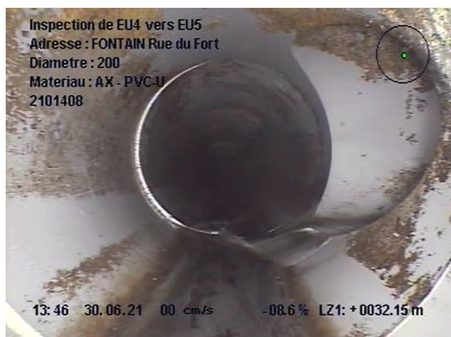
Arrivée d'eaux claires d'un branchement (Tronçon EU4-EU5)
