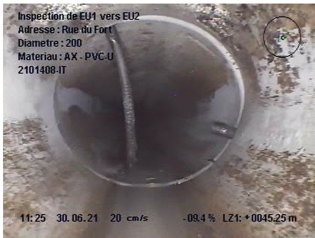
Joint défectueux pénétrant (Tronçon EU1-EU2)
