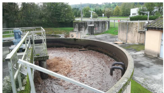
Figure 20 : Photos de la station d'épuration
