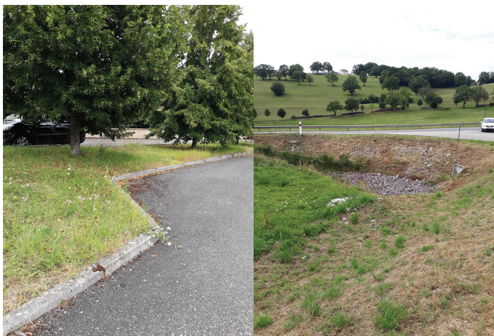
Figure 15 : Bassin de stockage rue de la Combe Bourgogne (à gauche) et route de Pugey (à droite)
