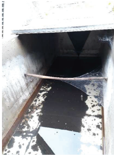
Figure 28 : Canal venturi de la STEP
