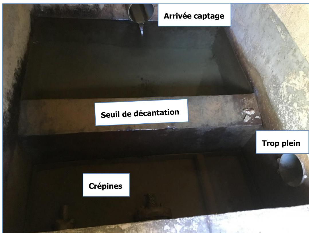
Photo 4 : Chambre des vannes de la source de Prati
