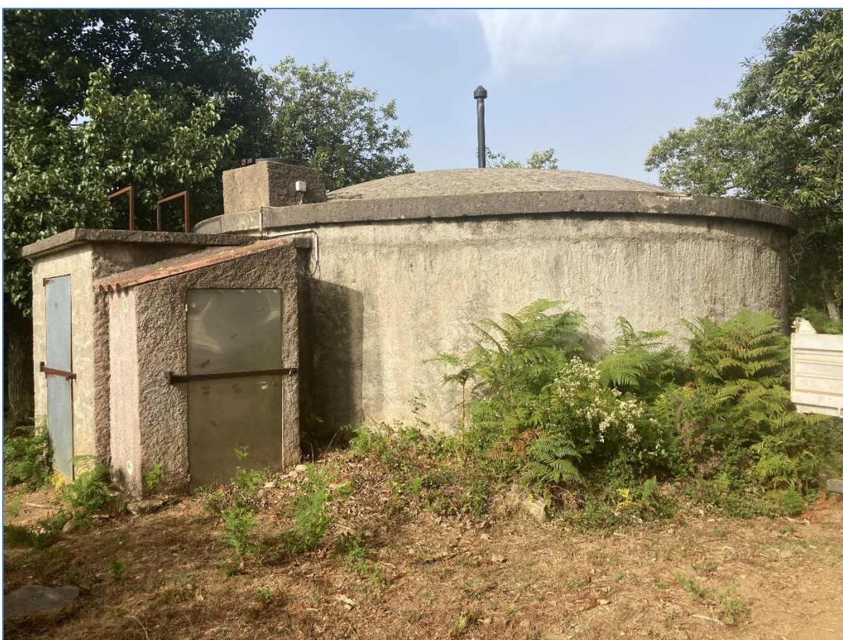
Photo 5 : Réservoir de Punta
