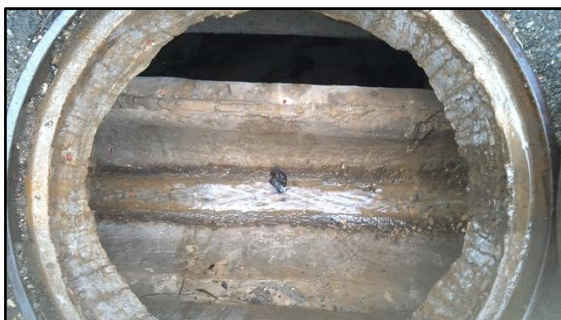
Figure 14 : Exemple de lame déversante
