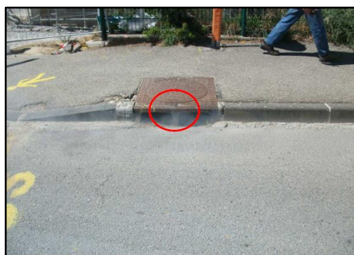
Figure 23 : Grille EP - Avenue Brossolette (PMH - 2011)
