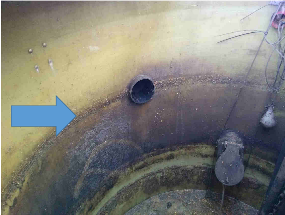
Photo 5 : Intérieur du poste de relevage de la station avec signe de by-pass récent
