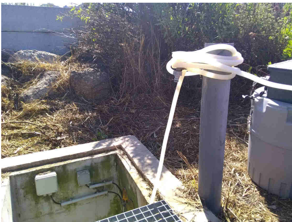
Photo 9 : Canal de comptage de l'effluent traité avec matériel de prélèvement installé.
