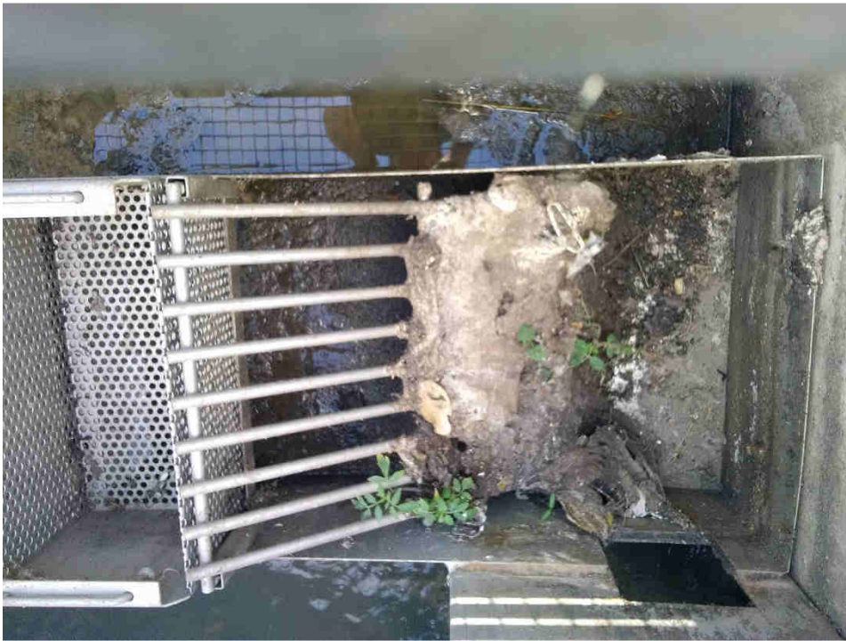
Photo 1 : Dégriateur statique en by-pass du dégrilleur automatique, présentant de nombreux déchets suite à dysfonctionnement du dégrilleur automatique.
