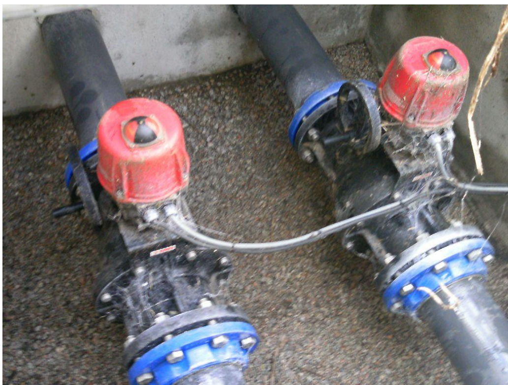
Photo N°21 : Electrovanes d'alimentation des filtres B1 et B2.
