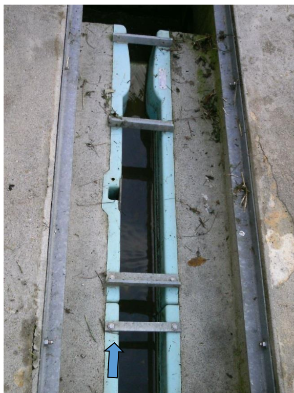
Photo N°6 : Canal de comptage de l'effluent en entrée station. Présence de sable dans le canal à évacuer. La flèche indique le sens de l'écoulement vers les ouvrages situés à l'aval.
