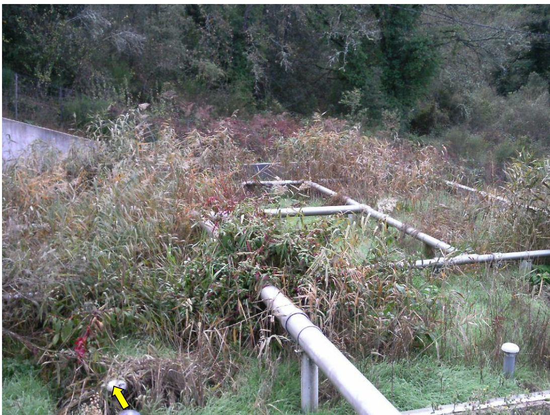
Photo N°12 : Filtre A1. La flèche jaune indique l'arrivée du trop-plein en cas de dysfonctionnement de l'ouvrage de bâchées. La coupe des roseaux sur l'ensemble des filtres du 1 er et du 2 nd étage a été réalisée au mois de mars 2021.
