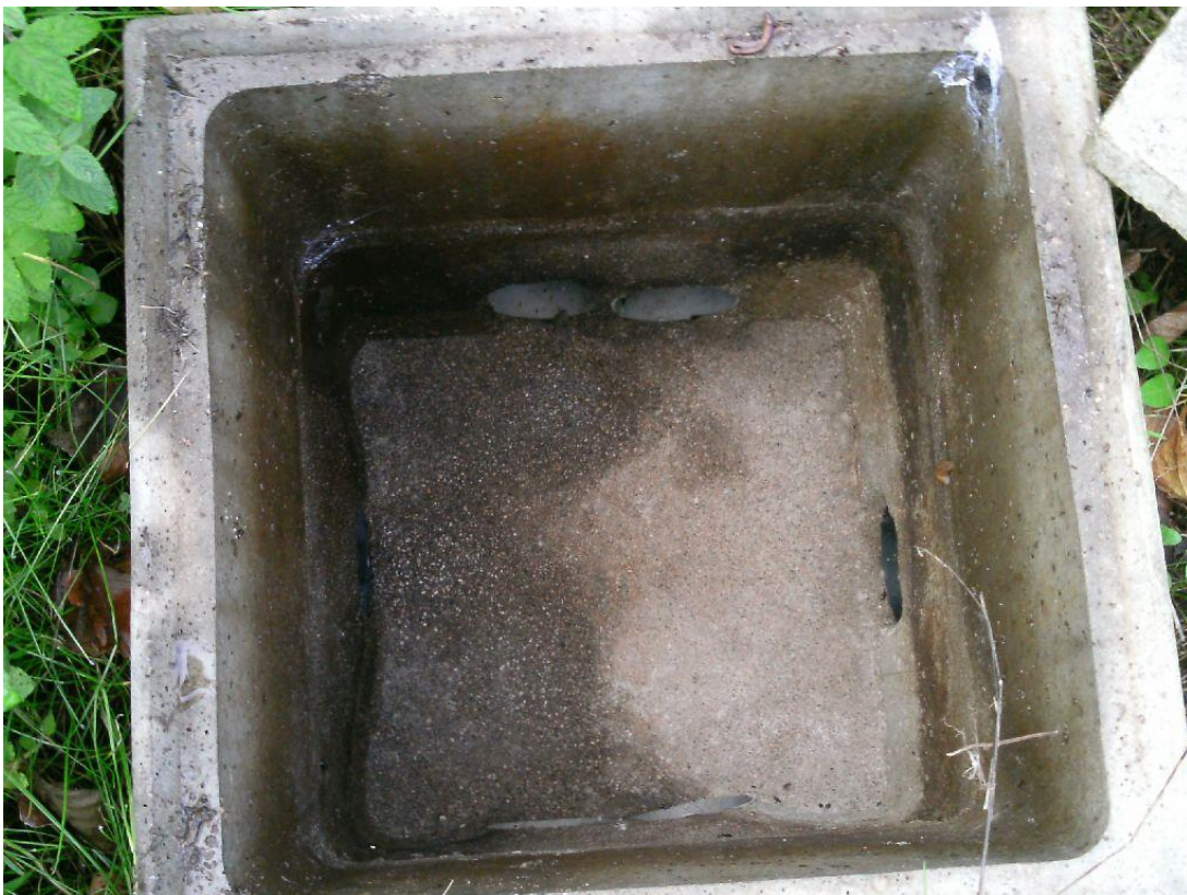
Photo N°32 : Regard de répartition le plus proche du canal de comptage de l'effluent traité qui n'était pas alimenté ce jour.
