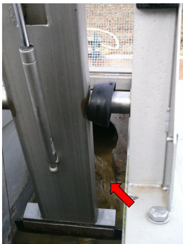
Photo N°4 : Présence de déchets (lingettes ?) au niveau de la conduite d'amenée de l'effluent au dégrilleur. Procéder à une campagne d'information (cf. exemples fournis en fin de la série de photos) pour demander aux usagers raccordés au réseau d'assainissement de ne plus envoyer de lingettes.
