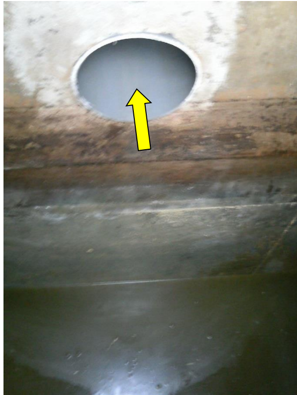
Photo N°11 : Départ du trop-plein.
