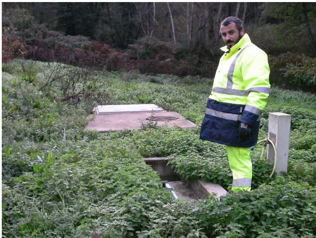
Photo N°24 : M. MARTINETTI (préposé communal) au niveau du canal de comptage de l'effluent traité.
