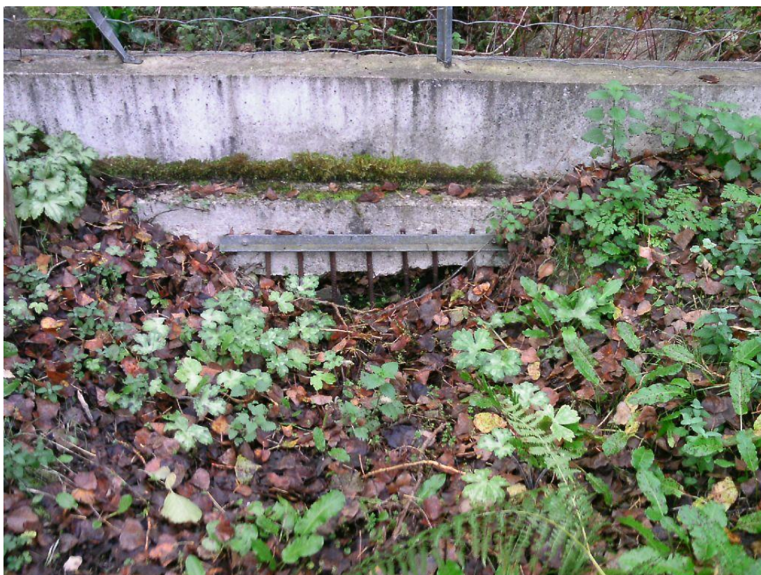
Photo N°34 : Evacuation du pluvial partie gauche de l'enceinte de la station.
