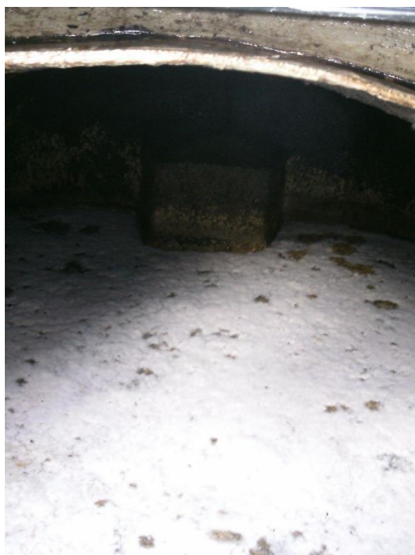
Photo N°8 : Départ de l'effluent du débourbeur vers l'ouvrage de chasse alimentant les filtres du 1 er étage.
