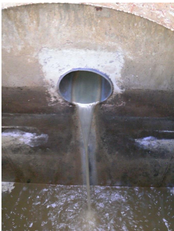
Photo N°9 : Arrivée de l'effluent à traiter au niveau de l'ouvrage de chasse alimentant les filtres du 1 er étage.
