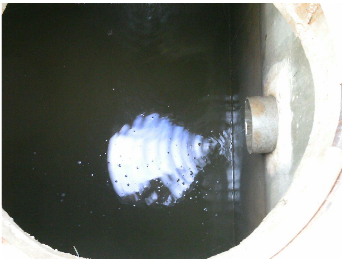
Photo N°19 : Arrivée de l'effluent dans l'ouvrage de chasse alimentant les filtres du 2 nd étage.
