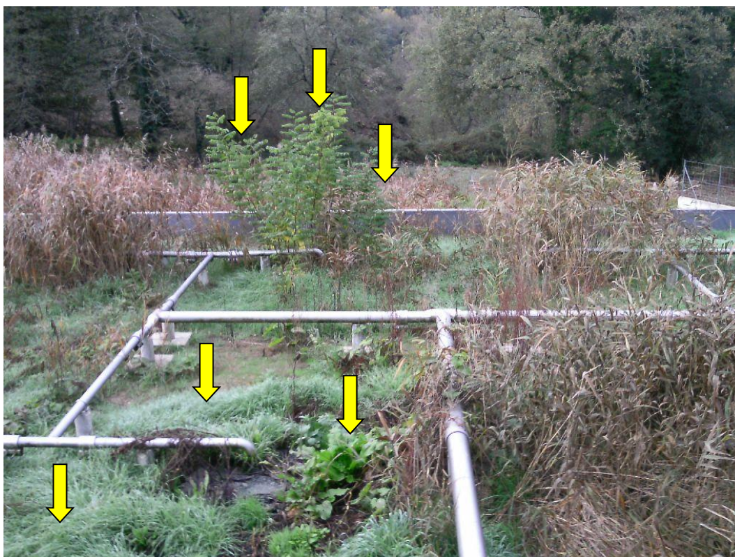
Photo N°17 : Vue du filtre A3. Profiter de l'humidité très importante présente actuellement au niveau du matériau filtrant pour tenter d'arracher au maximum plantes adventices et arbustes qui ont poussé à l'intérieur des filtres du 1 er étage.
