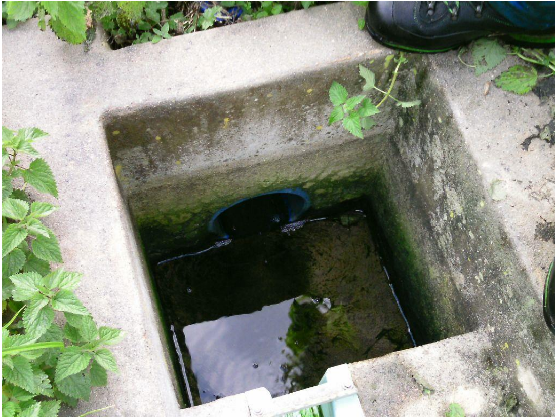
Photo N°27 : Sur-profondeur en sortie du canal.
