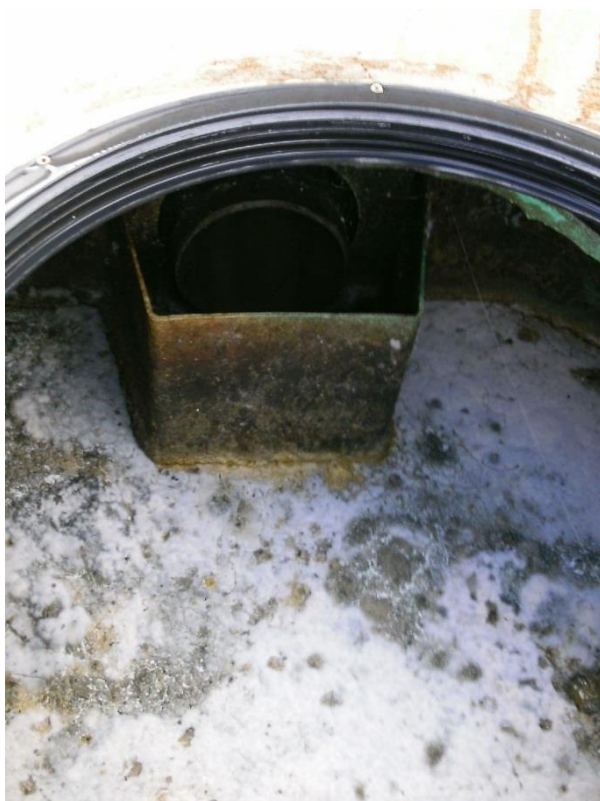
Photo N°7 : Arrivée de l'effluent au niveau du débourbeur. Les boues remontées à la surface du débourbeur sont cassées tous les vendredis pour permettre l'implantation d'une banquette de boues à la surface des filtres du 1 er étage alimentés.
