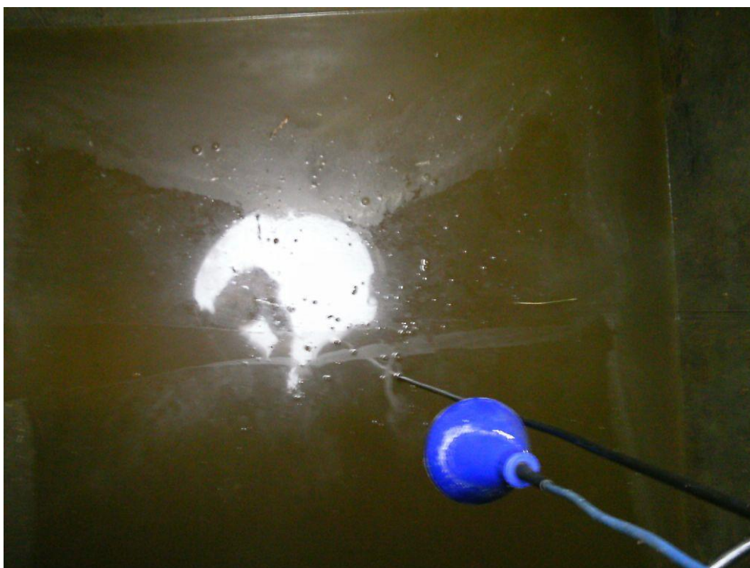
Photo N°10 : Sonde piézométrique au fond de l'ouvrage (câble noir) qui permet le déclenchement des bâchées (via l'automate) et poire de niveau qui comptabilise les départs par le trop-plein de la chasse (vers le filtre A1) en cas de dysfonctionnement de l'automate, de la sonde piézo ou de panne EDF).
