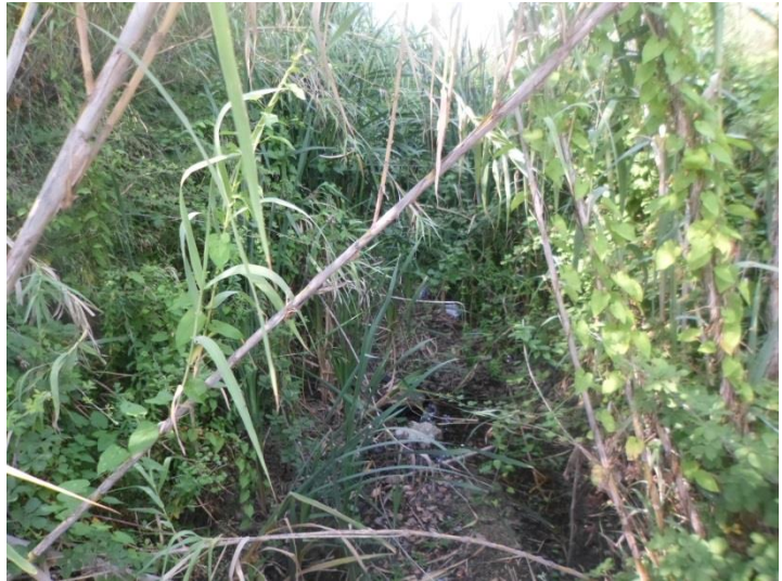
Fossé encombré près du giratoire de la Moutonne
