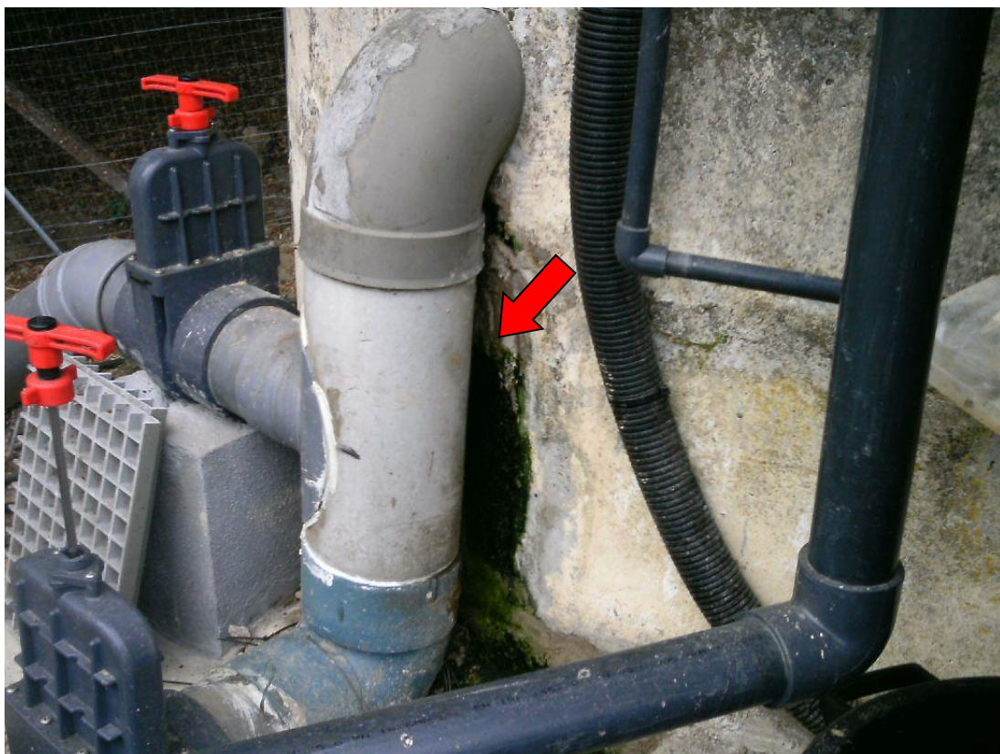
Photo N°4 : Suintement en sortie du dégrilleur vers les canaux dessableurs.
