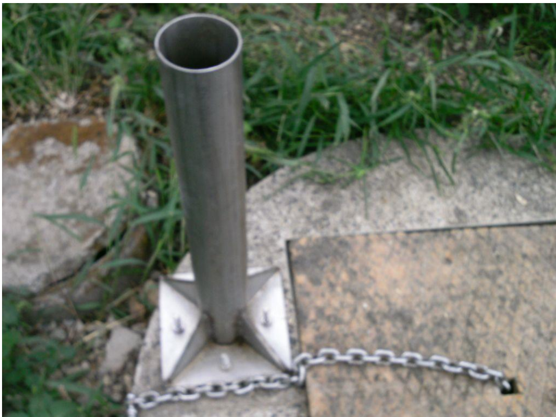
Photo N°30 : Potence permettant de sortir la pompe de refoulement des eaux d'égoutture.
