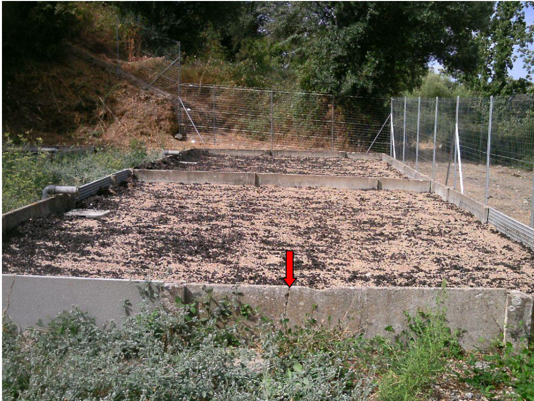
Photo N°11 : Quelques fissures à reprendre...
