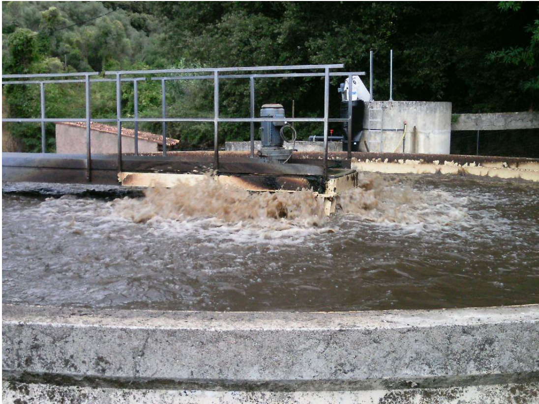
Photo N°7 : Turbine en fonctionnement ce jour.
