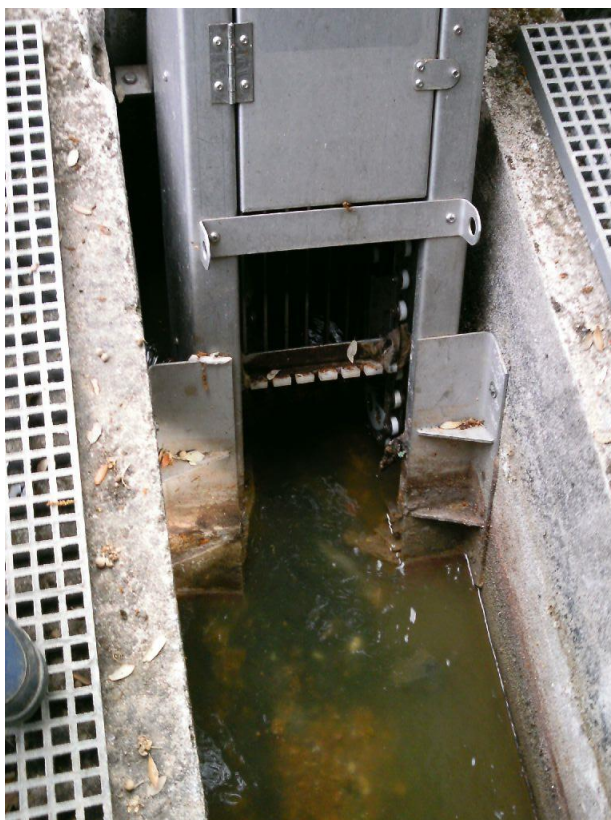
Photo N°16 : Dégrilleur droit automatique.
