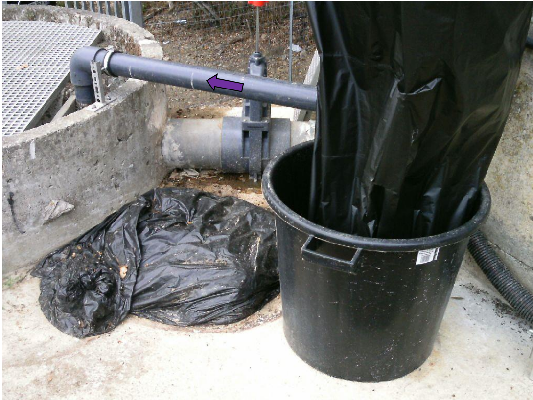
Photo N°19 : Eau de lavage de la vis sans fin et du compacteur au niveau de l'arrivée de l'effluent vers les canaux dessableurs.
