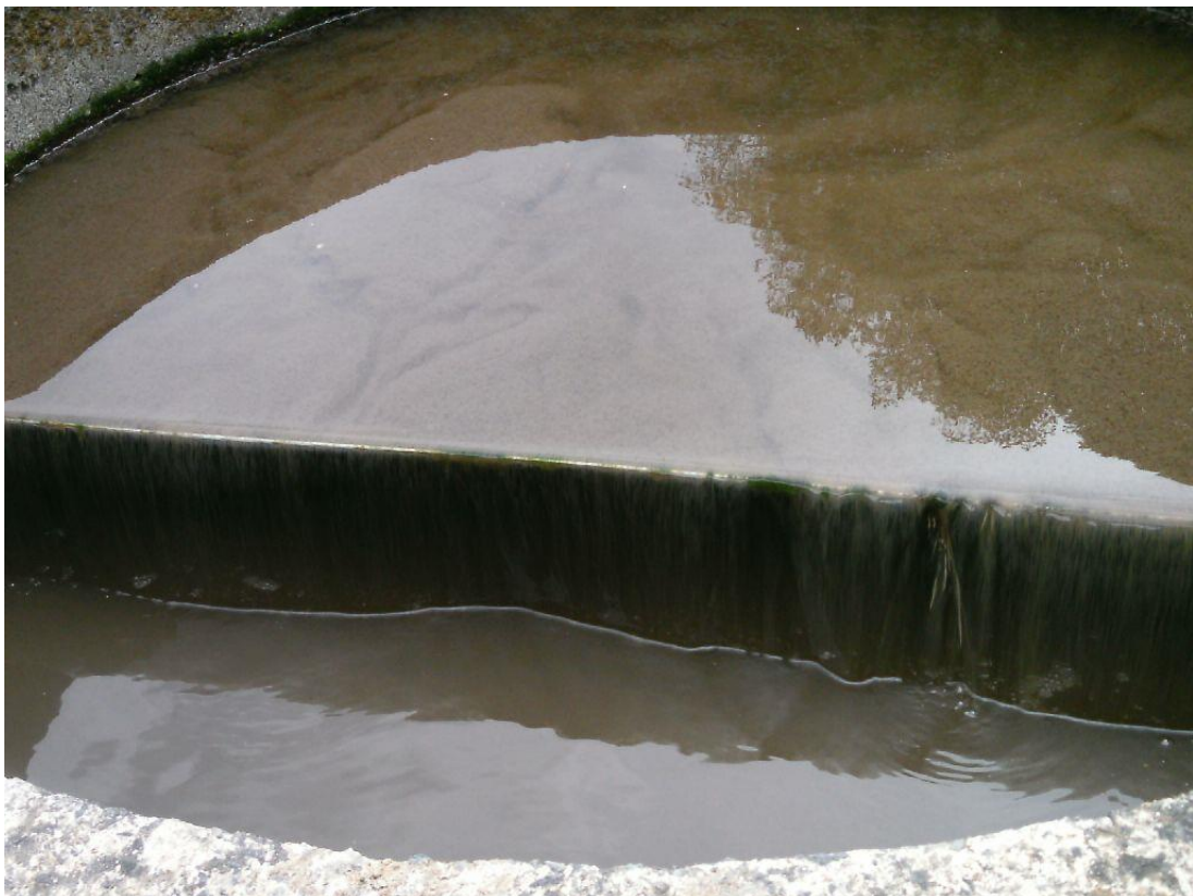
Photo N°10 : Lame crénelée au niveau du dégazeur qu'il faudrait reprofiler pour diminuer le niveau dans le bassin d'aération de 2 à 3 cm environ.
