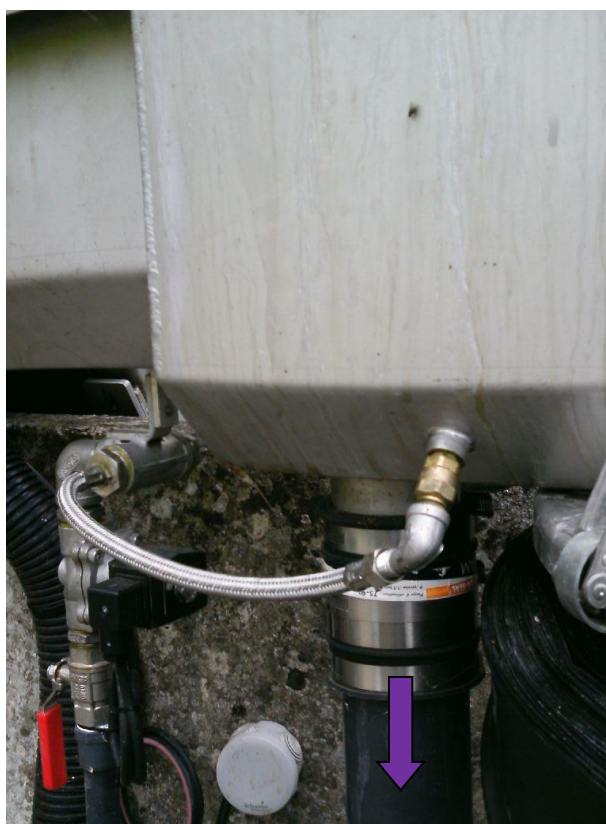
Photo N°18 : Electrovanne de lavage de la vis sans fin et du compacteur. La flèche violette indique le départ des eaux de lavage de la vis sans fin.
