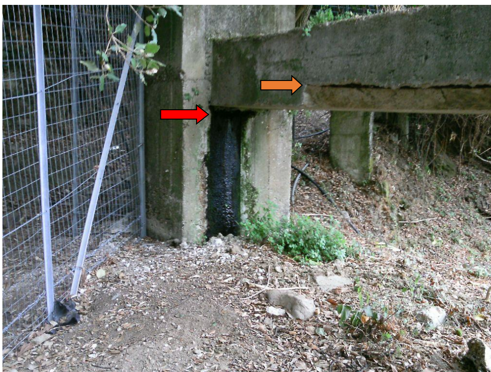
Photo N°2 : Détail et autre fissure signalée.
