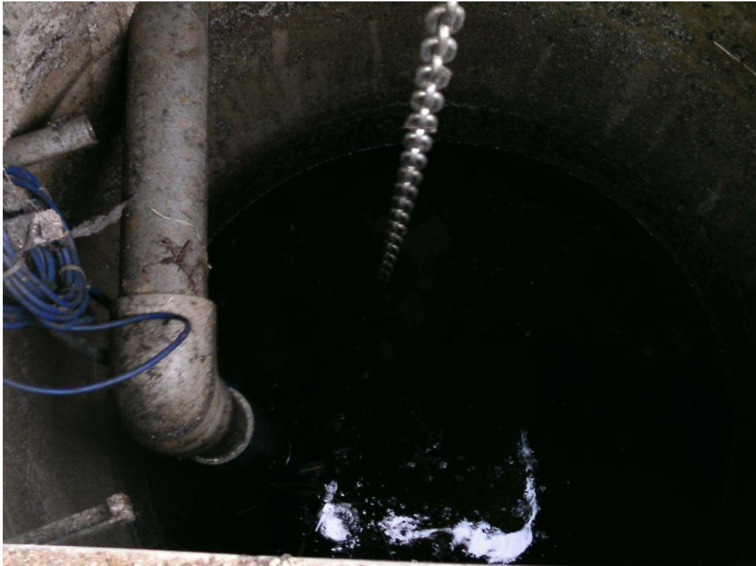
Photo N°29 : Poste toutes eaux = poste de refoulement des eaux d'égoutture des lits de séchage vers le bassin d'aération.
