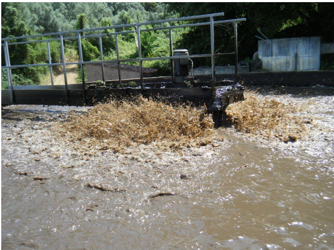
Photo N°8 : Turbine en fonctionnement le 25/06/12. Brassage plus efficient car la roue (volute) est moins immergée.
