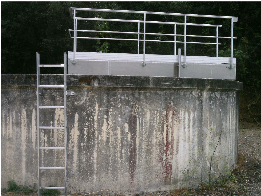
Photo N°22 : Pont racleur du clarificateur statique.
