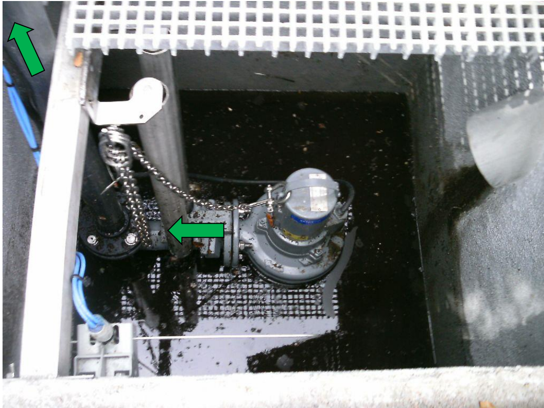
Photo N°23 : Poste de refoulement des flottants évacués de la surface du clarificateur par la lame de surface qui a été finalement mise en place. Les flottants sont évacués dans le lit de séchage des boues le plus proche du poste.
