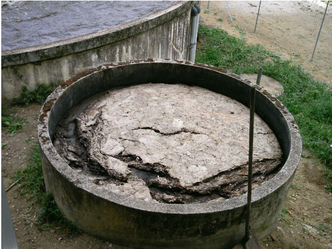
Photo N°21 : Dégraisseur statique avec couche de graisses et de boues remontées à sa surface. Faire intervenir un camion hydro-cureur pour curer l'ouvrage.
