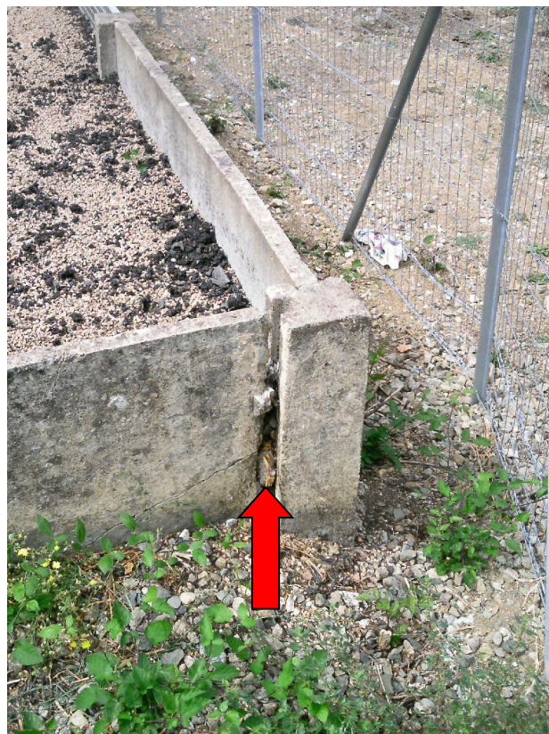
Photo N°12 : ...et écartements à combler au niveau des lits de séchage qui ont été réhabilités (remplacement des drains et du matériau filtrant).
