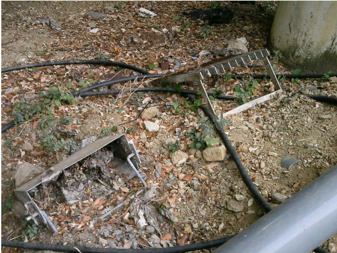
Photo N°31 : Ancien dégrilleur et panier dégrilleur à évacuer du site de la station.
