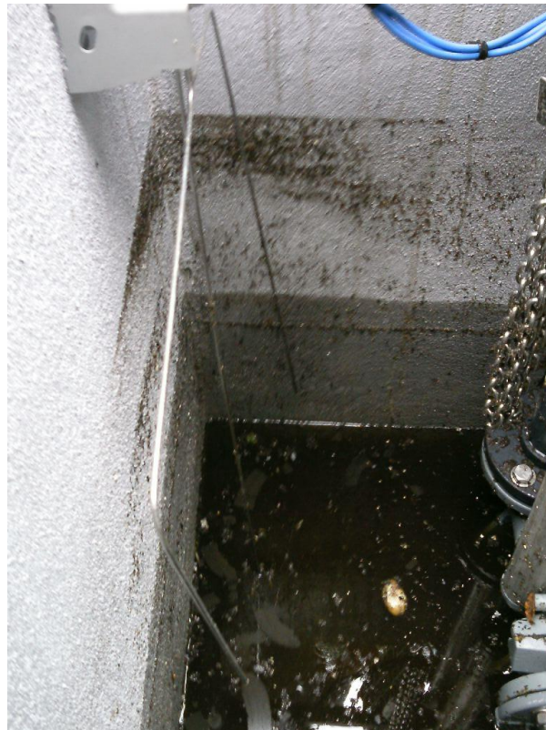
Photo N°24 : Système de tiges métalliques en remplacement des poires de niveau qui permet le déclenchement du poste de refoulement lorsque le niveau des tiges est atteint.
