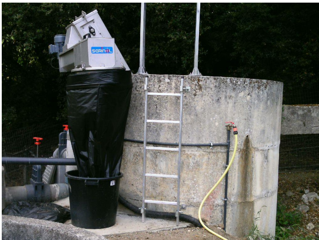
Photo N°17 : Evacuation des déchets dégrillés après compactage.
