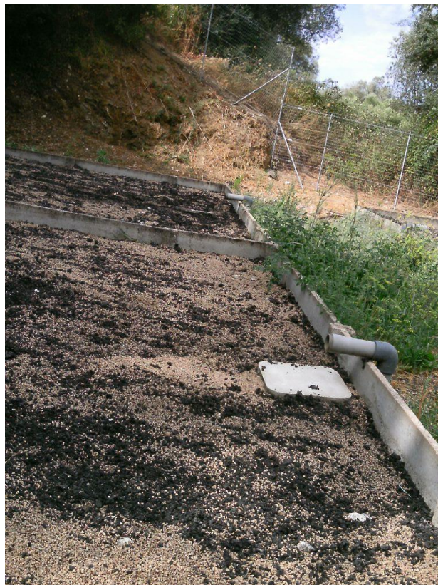
Photo N°26 : Conduite d'alimentation des boues vers les lits de séchage et plaques de dispersion dont la surface à l'air un peu petite.
