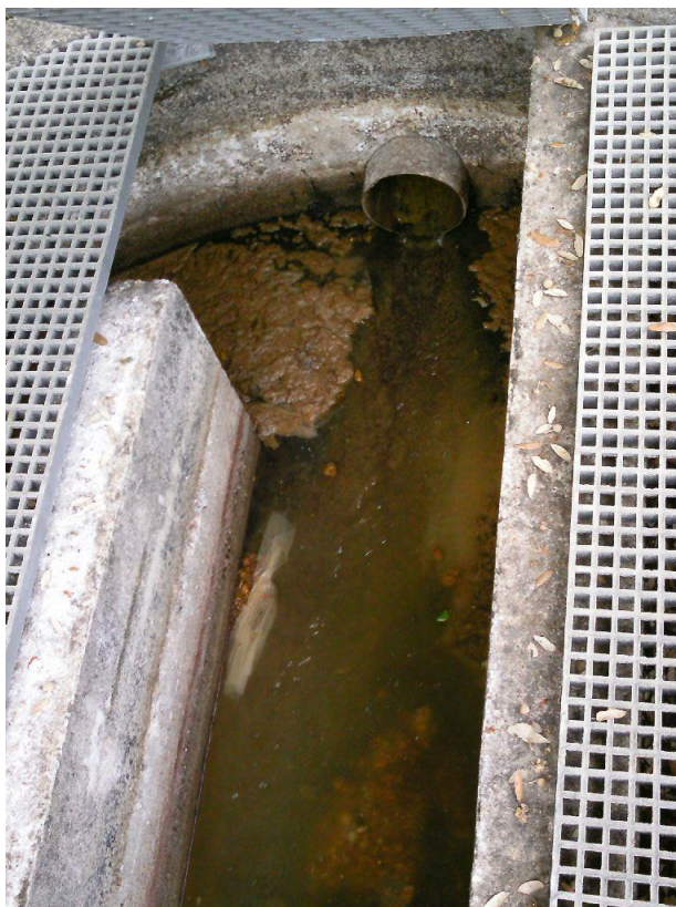
Photo N°15 : Arrivée de l'effluent au niveau du dégrilleur automatique.
