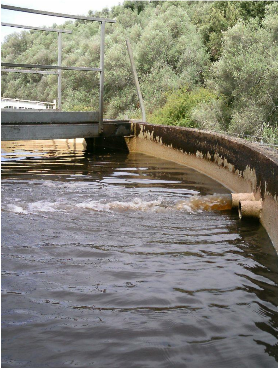
Photo N°5 : Refoulement dans le bassin d'aération de la pompe de recirculation. On notera que le niveau du bassin d'aération affleure presque le bas des deux conduites de refoulement (celle au premier plan correspondant au refoulement de la pompe toutes eaux. Photo à comparer avec la photo N°6.
