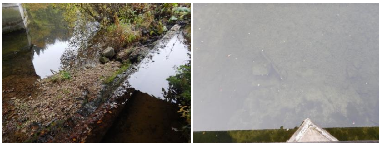
Figure 9. Désordres du pont de la Voyèze
