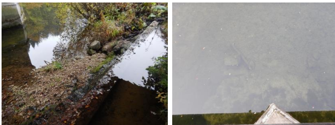
Fig. 43. Désordres du pont de la Voyèze
