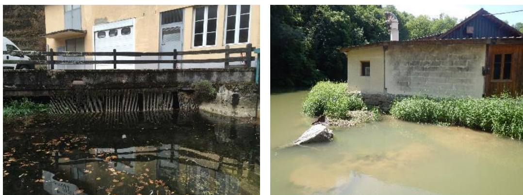
Fig. 54. Ensablement important et colmatage à l'entrée du canal usinier
