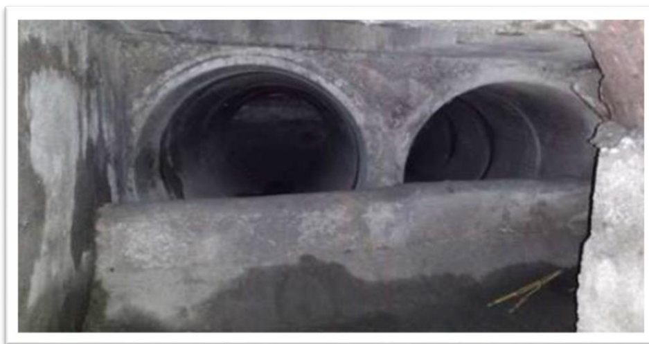
Figure 11 : Déversoir hydraulique du collecteur pluvial vers le réseau unitaire
