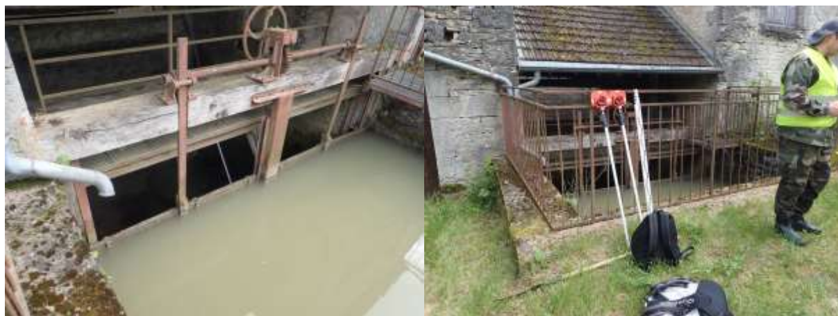
Figure 38 : Photographie du vannage du moulin Source : GRAINEau et SIGosphere
