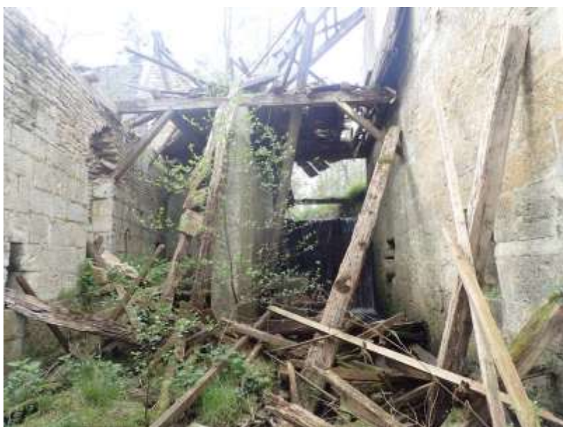
Figure 94 : Photographie de la chute du moulin (en arrière-plan) et illustration de l'état de délabrement du moulin Source : GRAINEau
