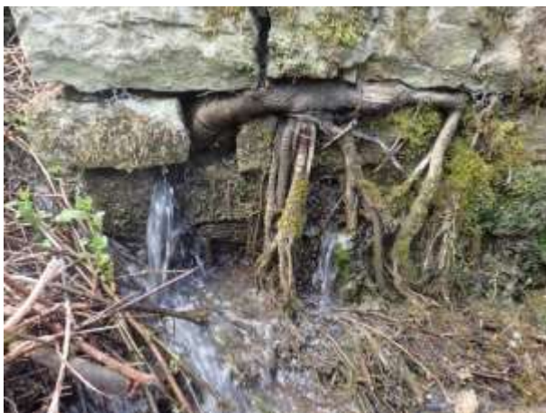
Figure 40 : Fuite à l'aval de l'ouvrage de franchissement au droit du profil en travers 74 Source : GRAINEau et SIGosphere
