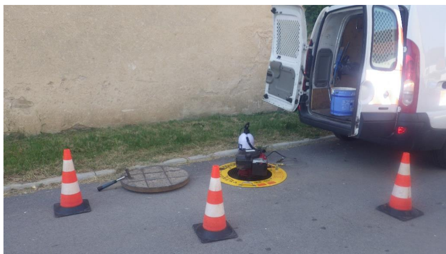
Figure 17 : Générateur de fumée en fonctionnement
