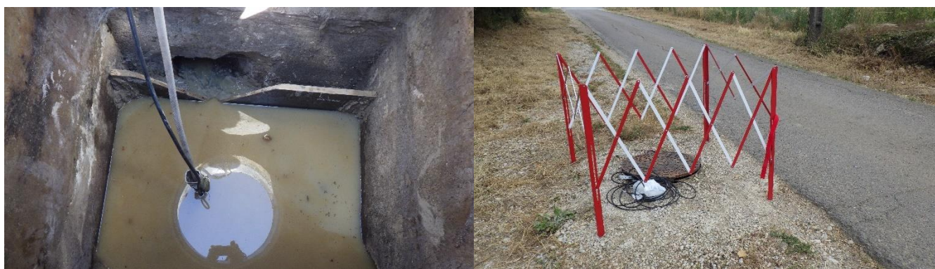
Figure 5 : Regard en entrée STEU équipé
