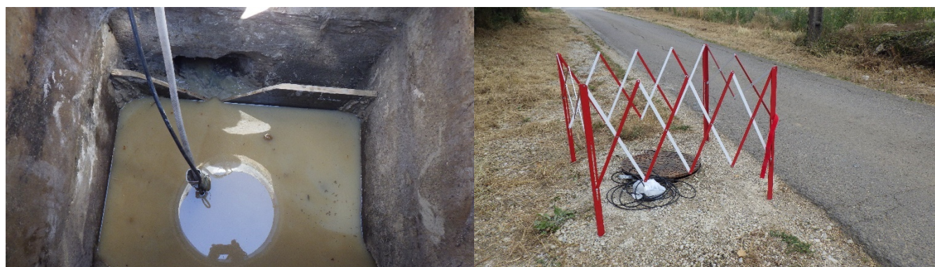
Figure 12 : Regard en entrée STEU équipé
