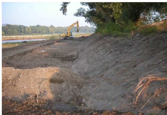
Figure 8 : Degré 3 – démantèlement total de la digue basse longitudinale – Marges alluviales de Pont St Esprit (Vieux-Rhône Donzère Mondragon).
