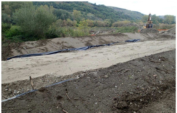
Figure 56 : Aire étanche de lavage – chantier de Serrières – Vieux-Rhône de Péage de Roussillon (oct. 2014)
