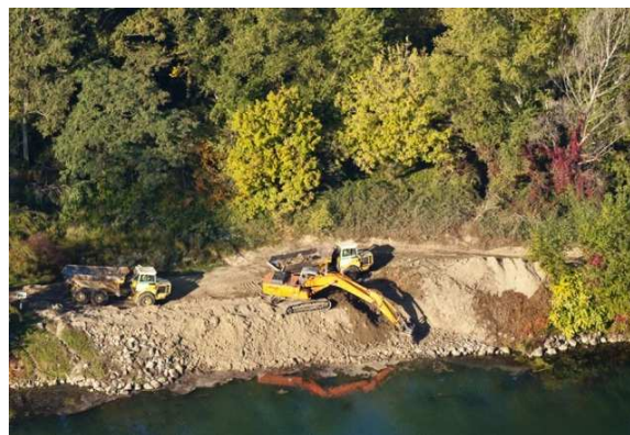
Figure 7 : Degré 2 – démantèlement partiel des ouvrages Girardon – Casiers de Cornas (vieux Rhône Bourg les Valence).
