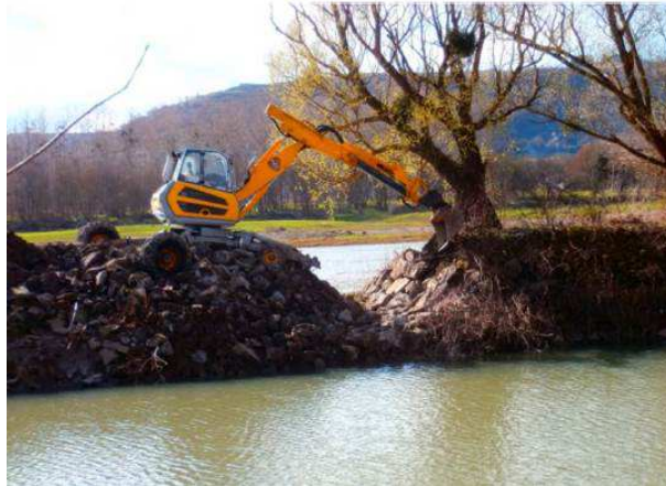
Degré 1 - brèche sur l'entonnement de la lône de la Platière (vieux-Rhône de Péage de Roussillon)
