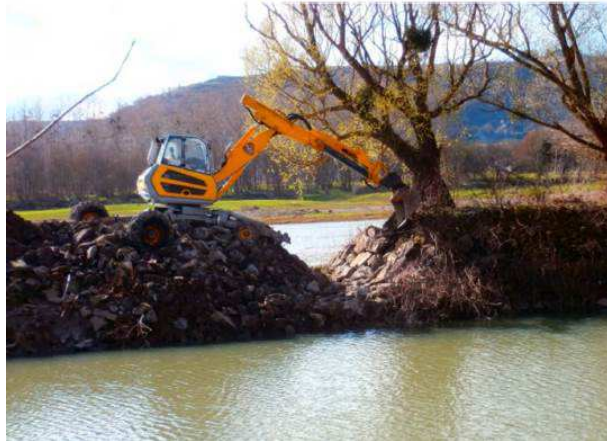
Degré 1 - brèche sur l'entonnement de la lône de la Platière (vieux-Rhône de Péage de Roussillon)
