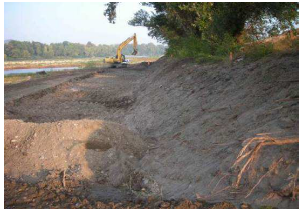
Degré 3 - démantèlement total de la digue basse longitudinale - Marges alluviales de Pont St Esprit (vieux-Rhône Donzère Mondragon)
