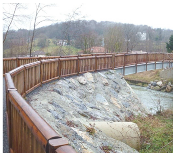
Figure 37 : Exemple d'une passerelle véloroute réalisée sur la Néez (longueur : 24m, largeur : 3 m)
