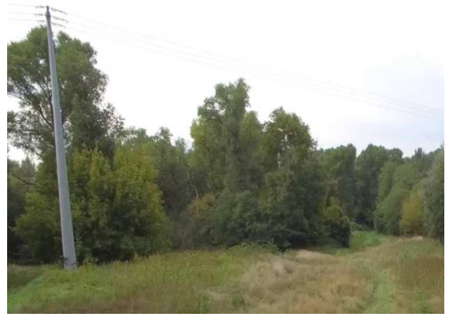
Figure 33 : Pylône électrique PK 176.000
