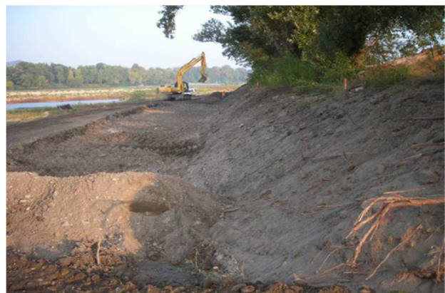
Figure 5 : Degré 3 – démantèlement total de la digue longitudinale – Marges alluviales de Pont St Esprit (vieux-Rhône de Donzère Mondragon).
