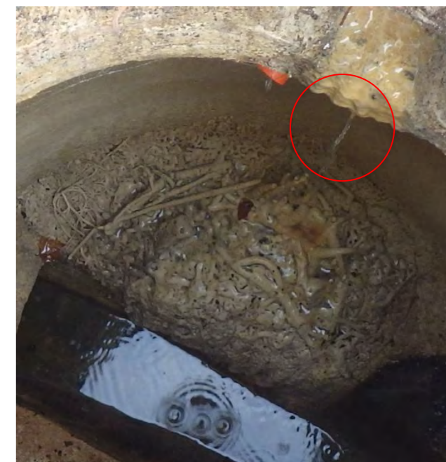
Regard n°170 – Infiltration par branchement – Callian Boulevard Amiral Rue.
