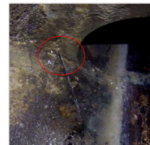
Regard n°36 – exemple d'infiltrations par virole – Callian - Chemin de l'Establerie (vidéo 9050)
