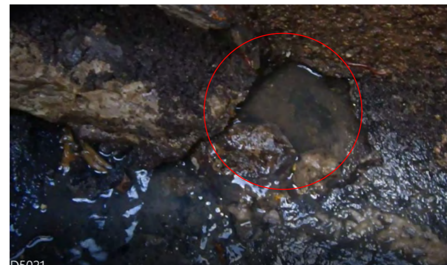
Regard n°412 – Infiltration par cunette/banquette -Montauroux Collet du Puits.
