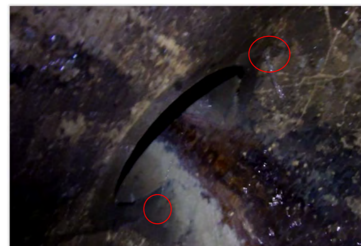
Regard n°442 – Exemple d'infiltrations multiples par virole /cunette – Callian - Lotissement du Vignaou (vidéo 9052)
