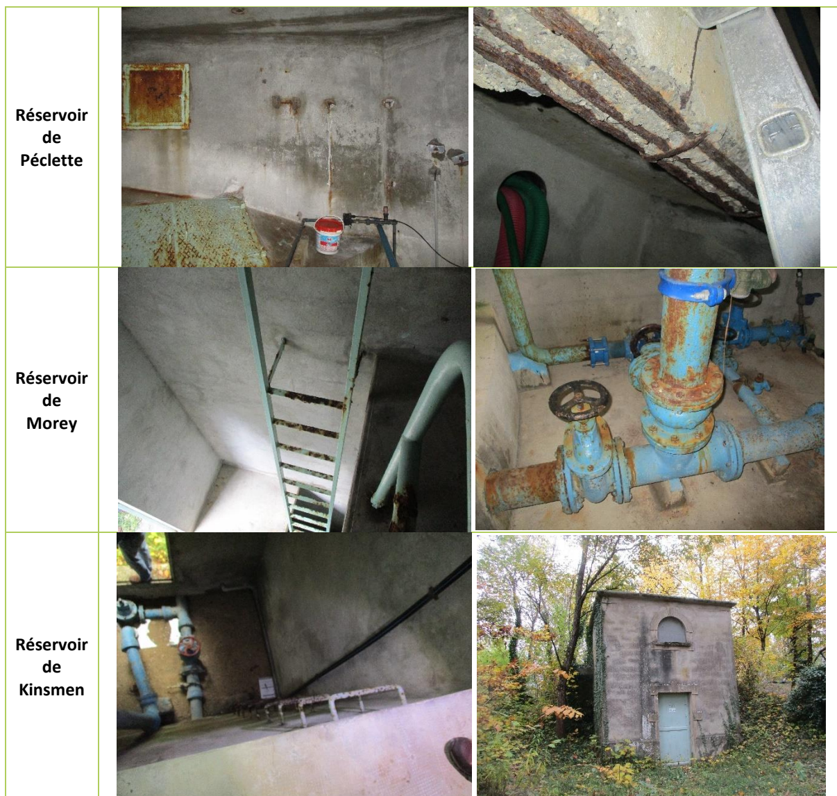
Figure 2 : Photos des désordres observés – réservoirs
