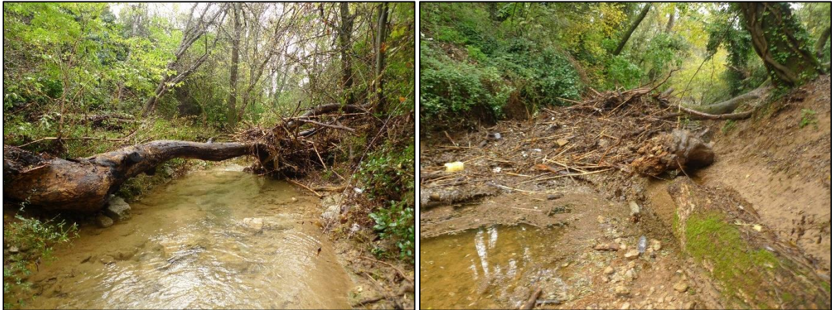
Exemple d'embâcles en partie médiane (à gauche) et à l'aval de la Cassole (à droite)
