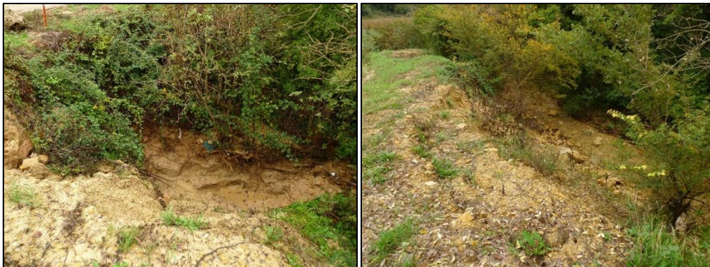
Exemples d'érosions de berge de rive gauche (Saint-Paul, commune de Carcès)
