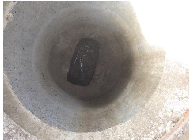
Chemin des Juillets – Regard 42 – Traces de mises en charge
