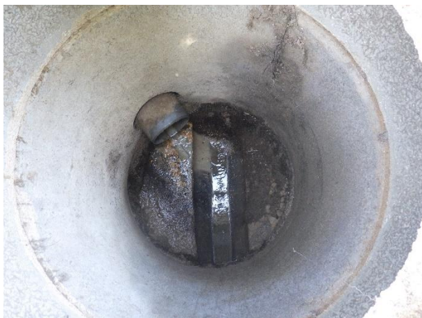
Enracinement total de la conduite - Regard 166 – Chemin du moulin
