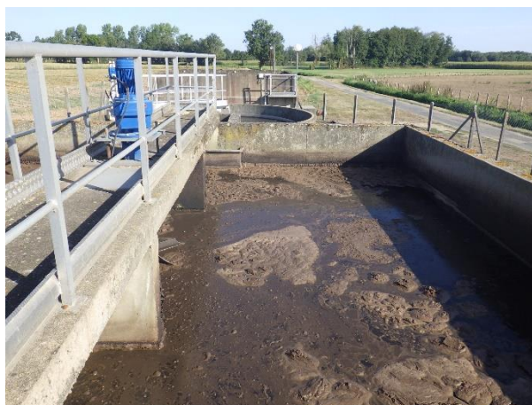
Vue intérieure de la STEU
