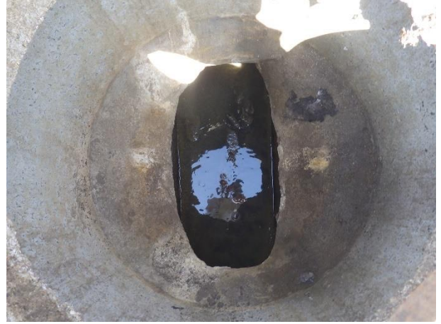
Présence de sables – Regard 155 – Chemin de Ravatoux
