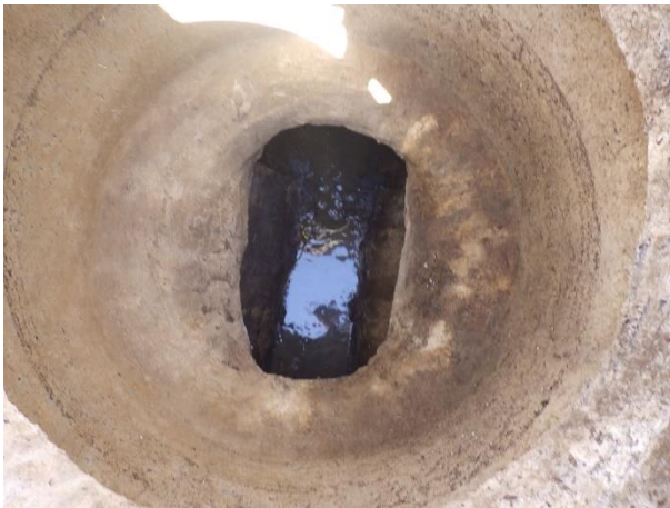
Chemin de Ravatoux - Regard 22 – Traces de mises en charge
