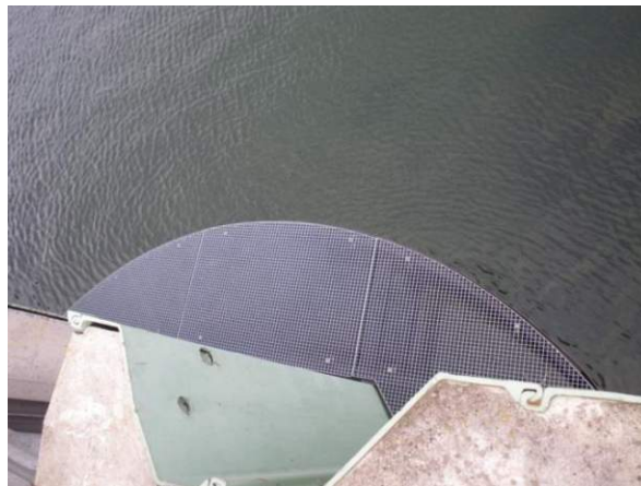
Fig. 21. Pare-embâcles en entrée de passe à poissons
