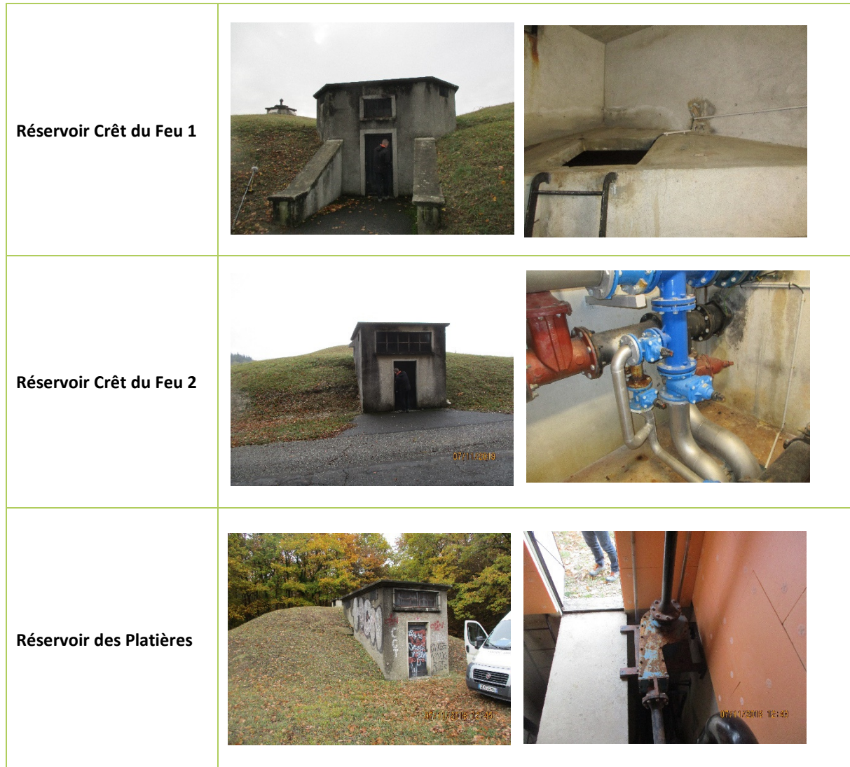
Figure 2 : photos des désordres observés
