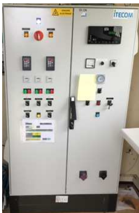
Armoire de commande et son SOFREL
