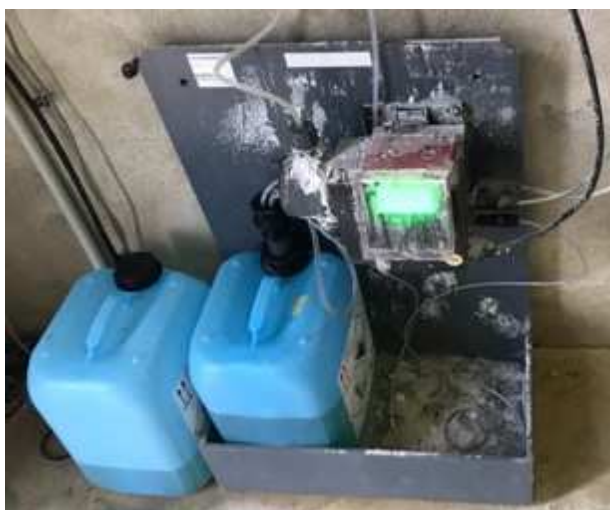
Unité de désinfection à l'hypochlorite de sodium
