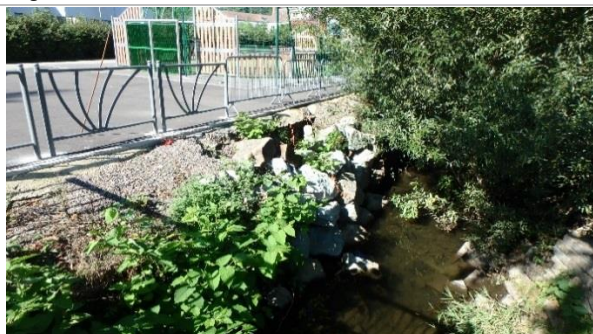
Enrochements effondrés à Rougemont-le-Château
