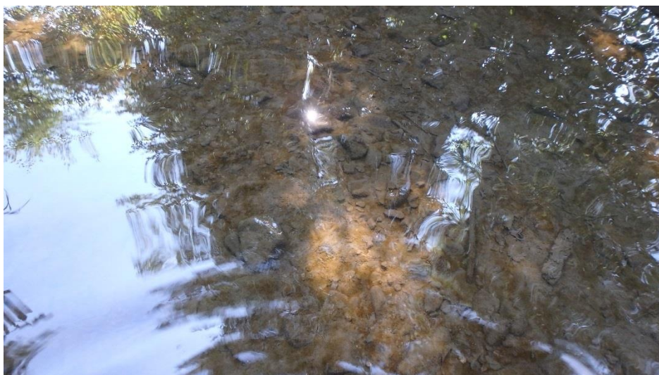
Figure 50 : Exemple de fond colmaté (amont de l'ouvrage en aval du pont rue Jean moulin à Rougemont-le-Château)
