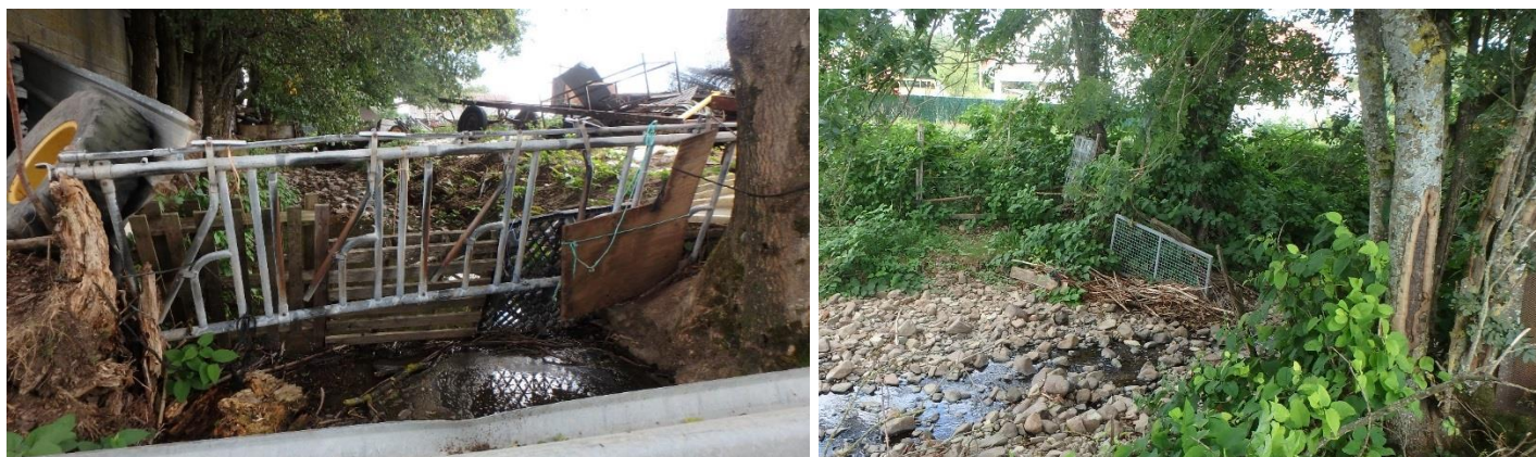
Figure 71 : Exemples de grilles potentiellement infranchissables (sur la Neuve Rivière à gauche et la Saint-Nicolas à droite)
