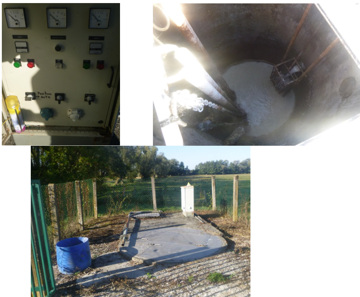
Figure 4 : Photographies du poste de refoulement principal
