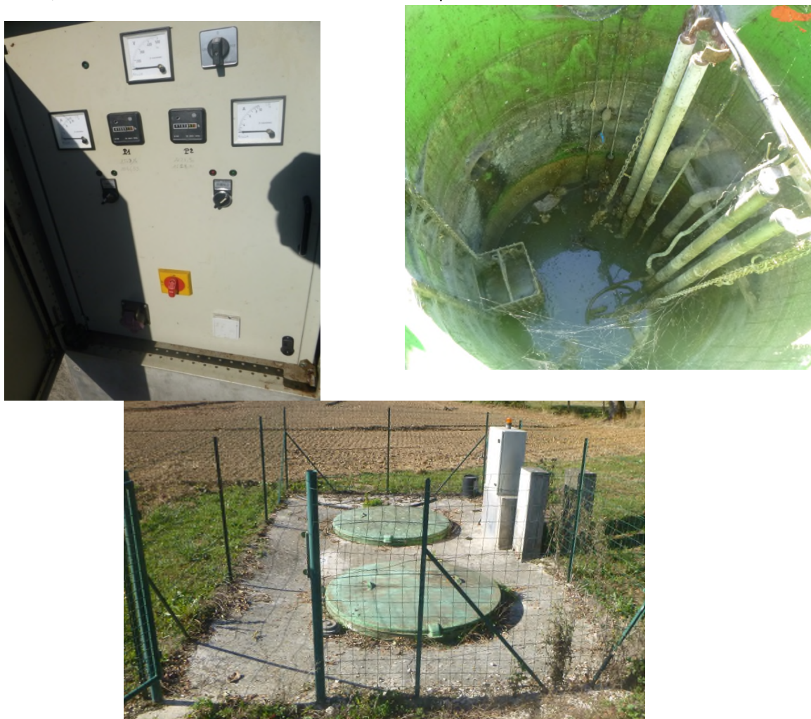
Figure 5 : Photographies du poste de refoulement n°2
