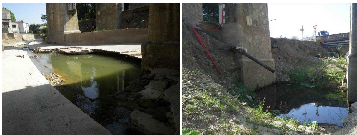
Lit bétonné endommagé et érosion de berge à l'arrière du chenal bétonnée à l'aval de la zone d'étude
