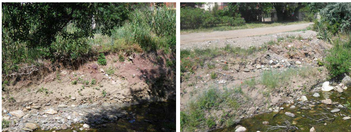
Matériaux constitutifs des berges sur le linéaire érodé
